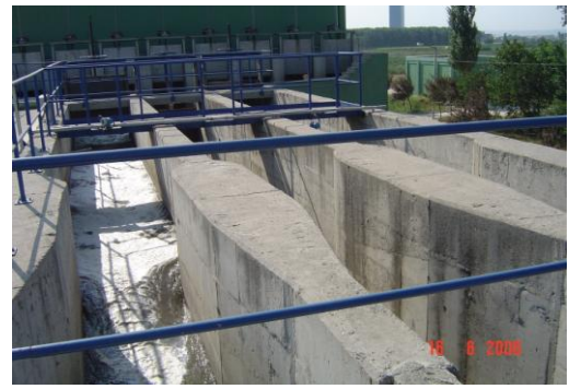
Şekil 3.6. Debi ölçüm ünitesi (Parshall Savağı) (Anonim 2006)
