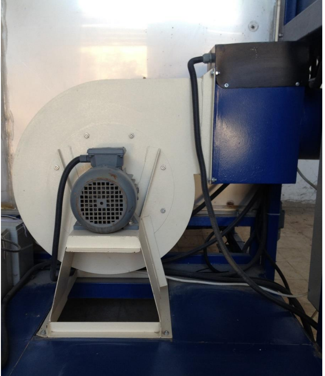
Şekil 3.9. Fan ve ısıtma üniteleri
