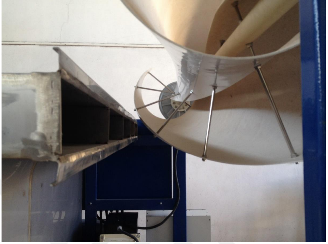
Şekil 3.6. Hava çıkış kanalı ve rüzgar türbini
