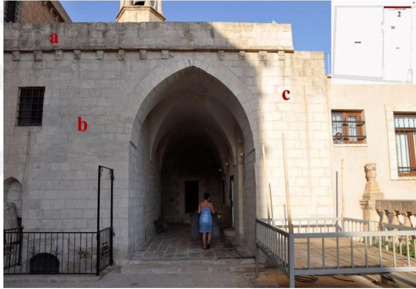
Şekil 4.502. Meryem Ana Kilisesi batı 2 numaralı duvarda malzeme bozulmaları
