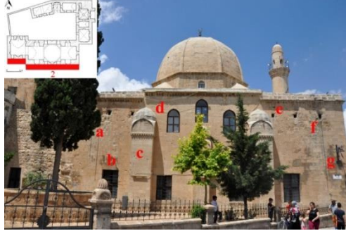
Şekil 4.61. Cami güney cephesindeki duvarlarda bozulmalar
