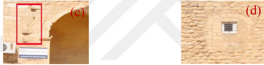
Şekil 4.31. Yüzey kaybı(c), hatalı onarım(d)
