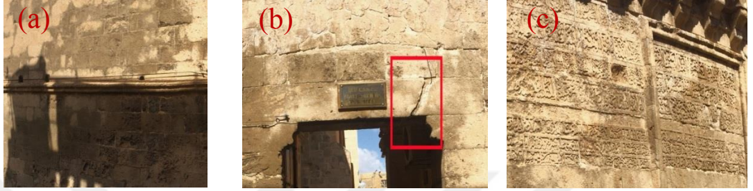
Şekil 4.25. Renk değişimi(a), çatlak(b), form kaybı(c)
