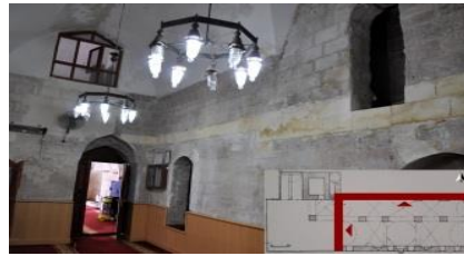
Şekil 4.268. İç mekânda duvarda hatalı onarım
