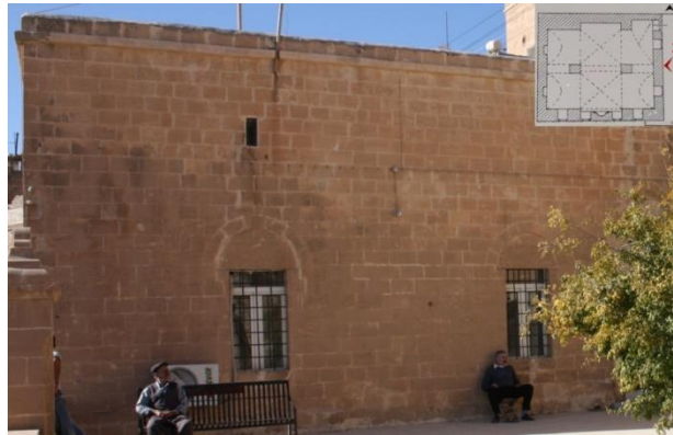
Şekil 4.155. 2 numaralı cephede duvarda renk değişimi, çimento kullanımı
