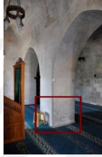
Şekil 4.191. İç mekândaki ayaklarda hatalı onarım
