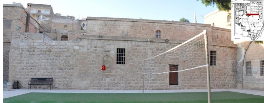
Şekil 4.479. Kırklar Kilisesi güney cephesi form kaybı(a)
