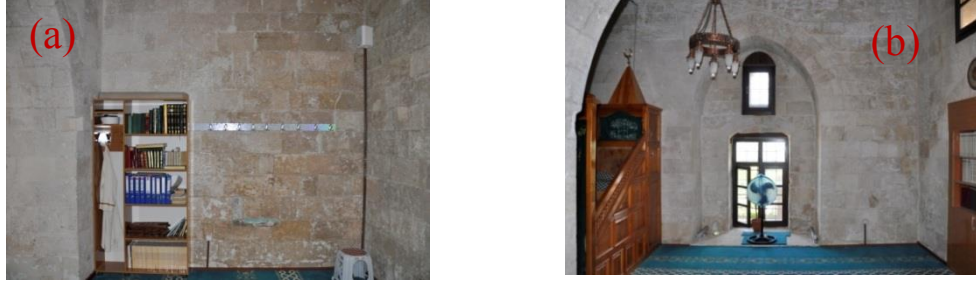
Şekil 4.197. İç mekân duvarlarında renk değişimi, hatalı onarım(a,b)
