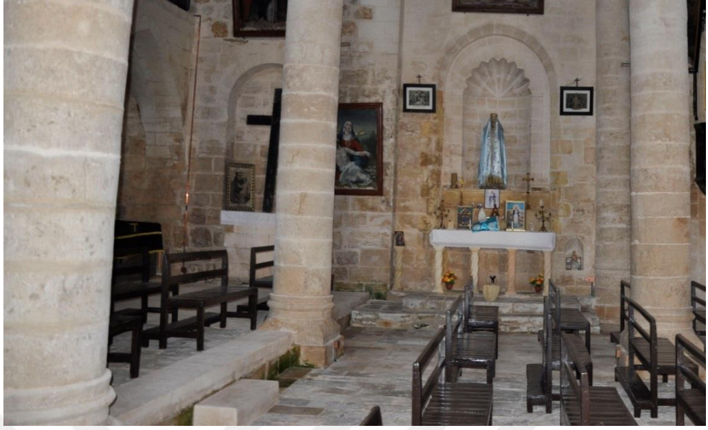
Şekil 4.510. 4 numaralı mekanda merdivende çiçeklenme, yosunlaşma, renk değişimi
