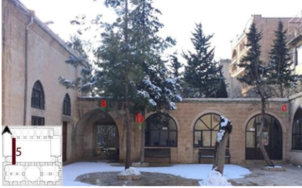
Şekil 4.125. Latifiye Cami batı cephesindeki duvarlarda oluşan bozulmalar
