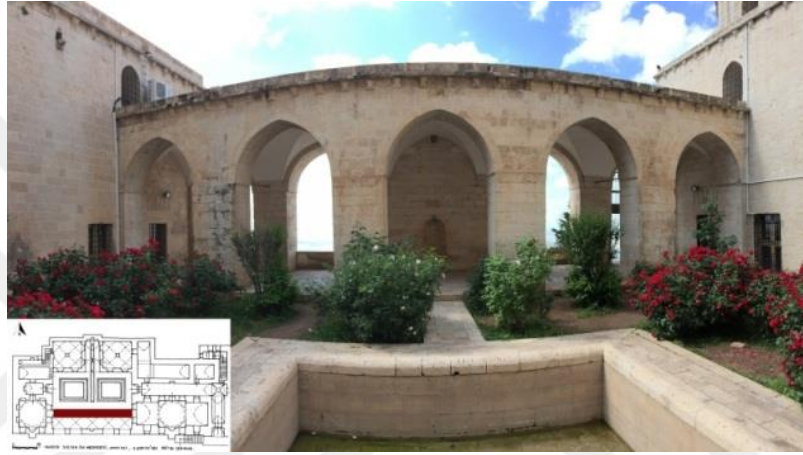
Şekil 4.406. Medrese avluya bakan kuzey cephesindeki duvarlarda hatalı onarım(çimento kullanımı)
