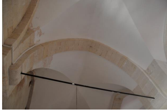
Şekil 4.296. 5 numaralı mekânda çapraz tonozda sıva dökülmesi
