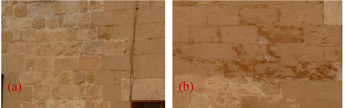
Şekil 4.172. Hatalı onarım(a), Renk değişimi(b)
