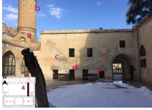
Şekil 4.122. 4 numaralı duvarlarda oluşan bozulmalar
