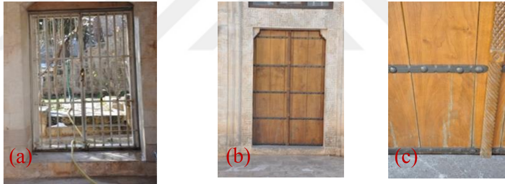
řekil 4.144. Batı cephesindeki metal kapıda paslanma(a), Gzney cephesindeki ahřap kapılarda nem sorunu, řatlak oluřumu, ahřap yzeyinde ařınma ve renk deęiřimi(b,c)
