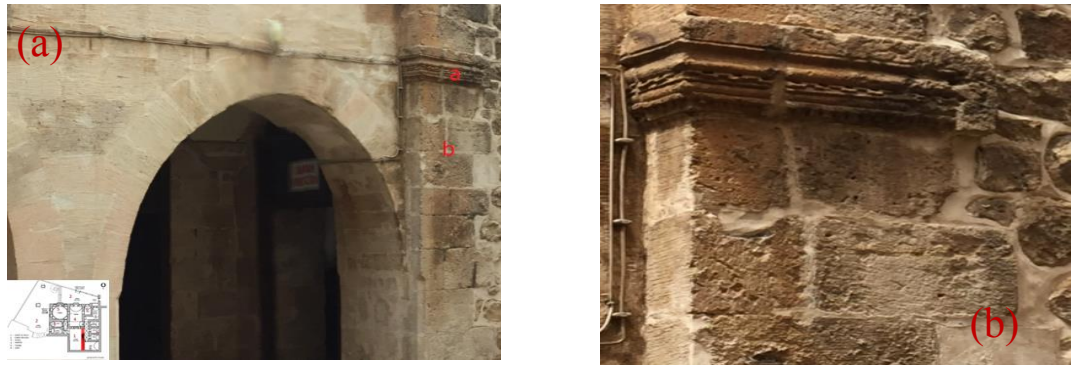
Şekil 4.313. Ayakta yüzey kaybı (a) , renk değişimi ve hatalı teknik onarım (b)
