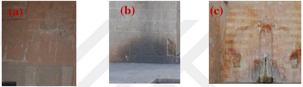
Şekil 4.453. Hatalı onarım(a), renk değişimi(b), renk değişimi ve form kaybı(c)
