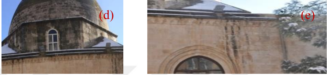
Şekil 4.116. Duvarda kabuk oluşumu ve yosunlaşma(d), yüzey kirliliği(e)
