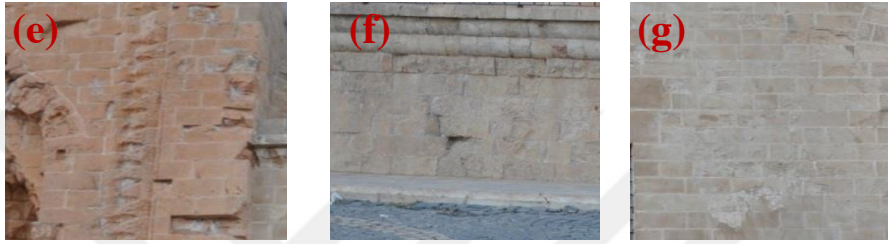
Şekil 4.450. Yüzey kaybı (e),yüzey kaybı(f), kavlanma (g)
