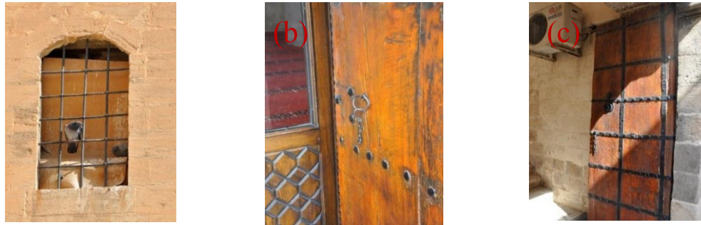
Şekil 4.44. Kuzey cephe özgün olmayan pencerede hatalı onarım(a), 6 numaralı kapıda aşınma(b),7 numaralı kapıda aşınma ve renk değişimi(c)
