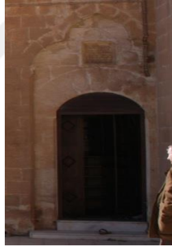
Şekil 4.161. Kapı üzerindeki kemerde çimento kullanımı
