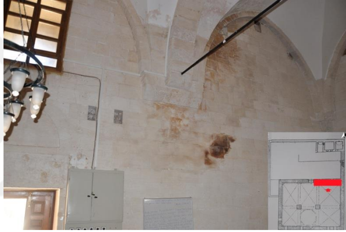
Şekil 4.292. Harim bölümünde iç mekânda duvarda renk değişimi
