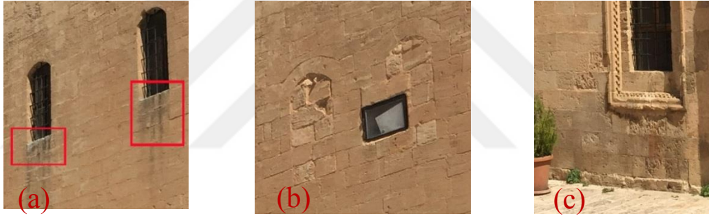
Şekil 4.18. Korozyon(pas lekesi)(a), hatalı onarım(b),oyuklanma ve renk değişimi(c)
