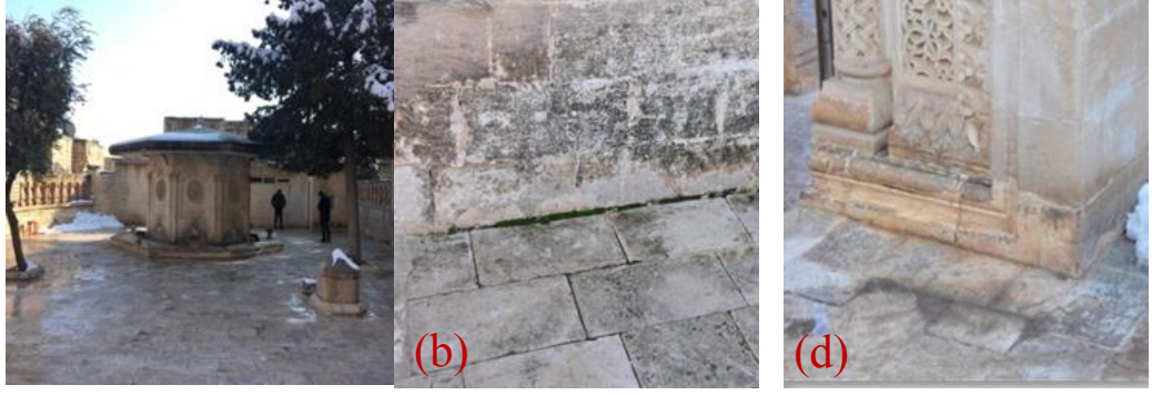
Şekil 4.132. Avlu zemin döşemesinde aşınma(a),avlu zemin döşemesinde taşlar arasında yosunlaşma(b), üst avlu döşemesi zemininde renk değişimi(d)
