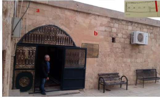
Şekil 4.175.Şeyh Çabuk Cami batı cephesinde duvarda derz boşalması(a),hatalı onarım(b)
