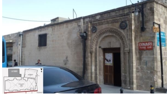
Şekil 4.216. Kuzey cephesinde yüzey kayıpları, yüzey kirliliği, renk değişimleri hatalı onarımlar
