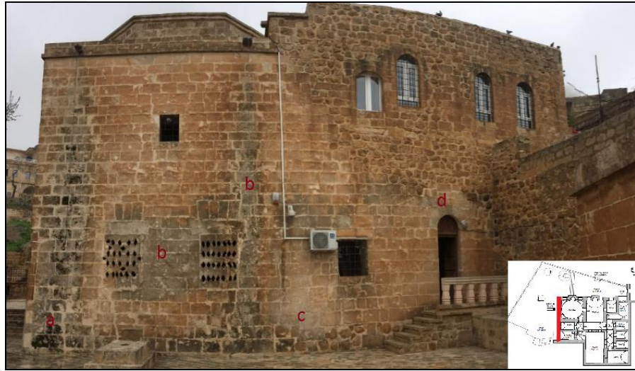
Şekil 4.320. Hatuniye Medresesi ön avluya bakan doğu cephesindeki duvarlarda bozulmalar
