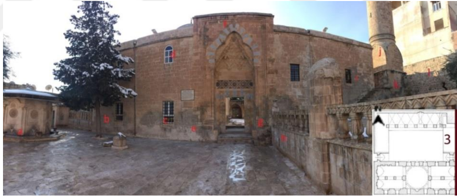
Şekil 4.117. Latifiye Cami 3 numaralı duvarlarda oluşan bozulmalar
