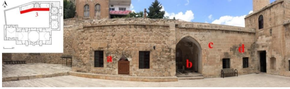
Şekil 4.65. Yapının avluya bakan güney cephesindeki duvarlarda oluşan bozulmalar
