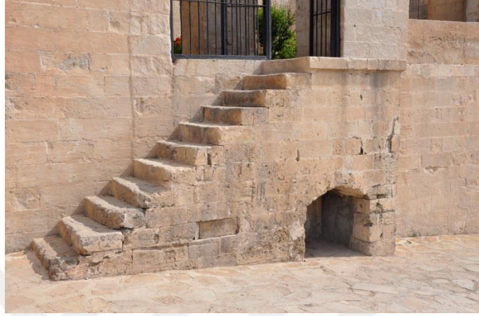
Şekil 4.426. Merdivende yüzey kaybı, aşınma
