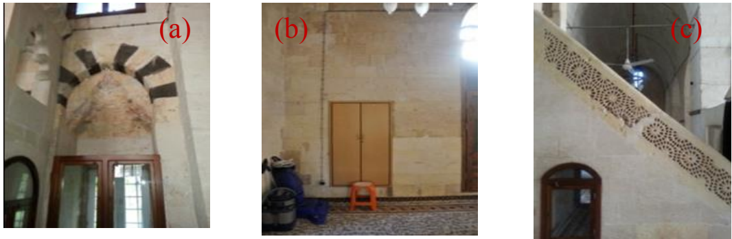
Şekil 4.127. İç mekânda form kaybı(a), iç duvarda hatalı onarım(b), duvarda hatalı onarım(c)
