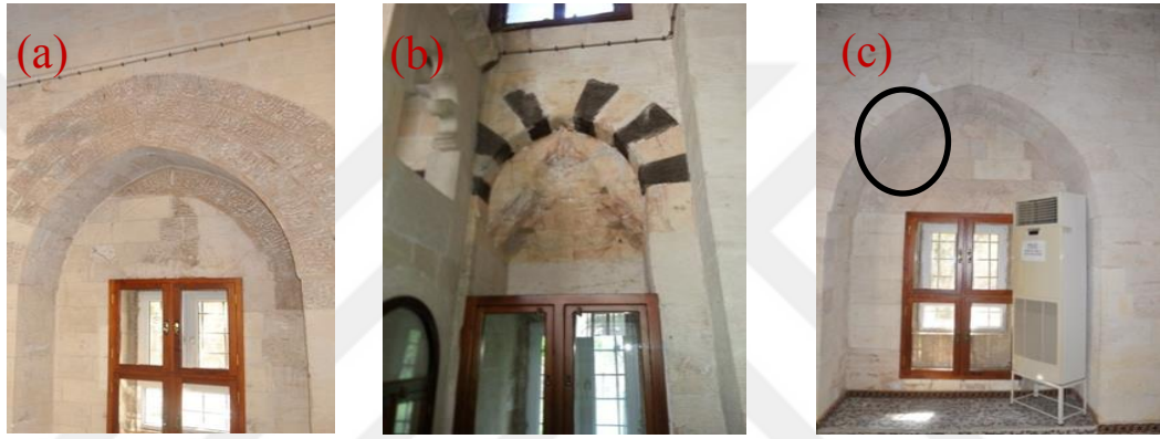
Şekil 4.146. Form kaybı(a), hatalı onarım(b), kavlanma(c)
