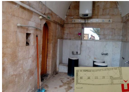
Şekil 4.176. Şeyh Çabuk Cami batı cephesinde duvarda renk değişimi, hatalı onarım
