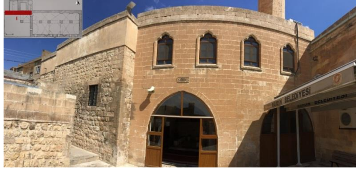
Şekil 4.262. Kuzey kanadı avluya bakan güney cephesindeki duvarlarda çimento kullanımı
