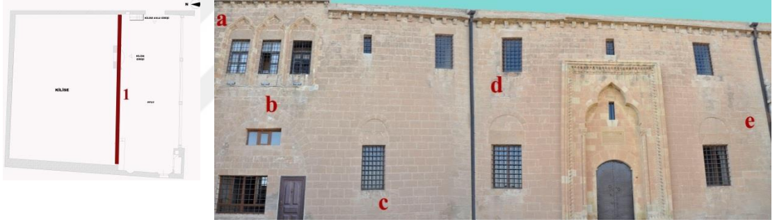
Şekil 4.499 . Meryem Ana Kilisesi 1 numaralı duvarlarda bozulmalar
