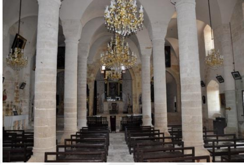
Şekil 4.497. Sütunlarda hatalı onarım(çimento kullanımı)
