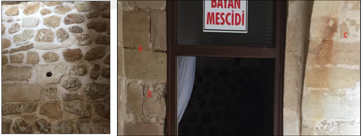
Şekil 4.328. Boşluk -delik, derz boşalması(a), yüzey kaybı(b), çimento kullanımı(c)
