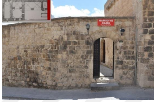
Şekil 4.238. Cami sokağa bakan doğu cephesindeki duvarda renk değişimi
