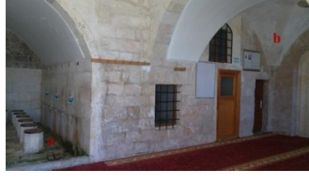
Şekil 4.272. 2 numaralı mekânda düz döşemede yosunlaşma(a), 5 numaralı mekânda çapraz tonozda sıva dökülmesi(b)
