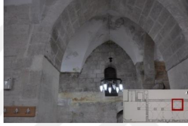
Şekil 4.273. Çapraz tonozda sıva dökülmesi
