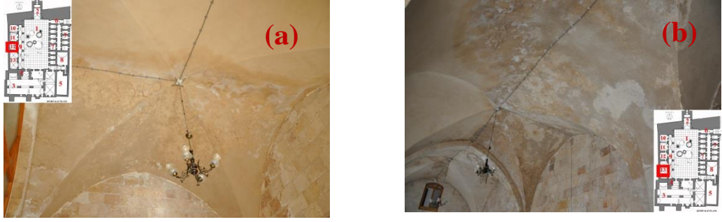
Şekil 4.379. 12 numaralı mekânda çapraz tonozda çiçeklenme(a), 13 numaralı mekânda çapraz tonozda çiçeklenme, renk değişimi(b)
