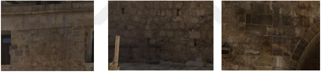
Şekil 4.195. Yüzey kirliliği(a), derz boşalması(b), yüzey kaybı(c)
