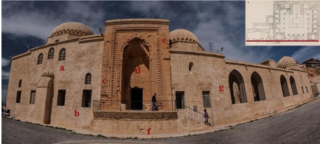
Şekil 4.448. Cami avluya bakan kuzey cephesindeki duvarlarda bozulmalar
