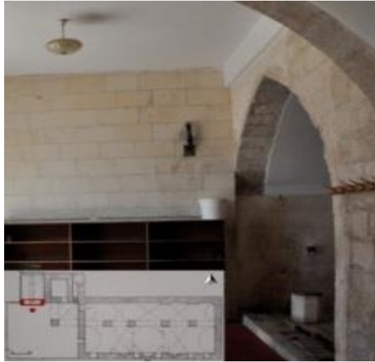
Şekil 4.278. Kemerde yüzey kaybı
