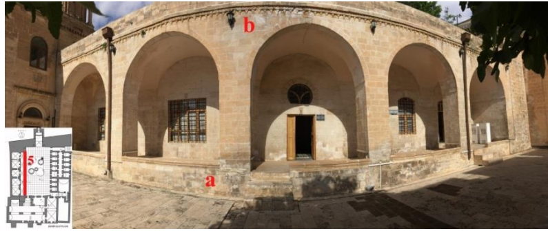
Şekil 4.373. Batı Cephesindeki duvarlarda oluşan bozulmalar
