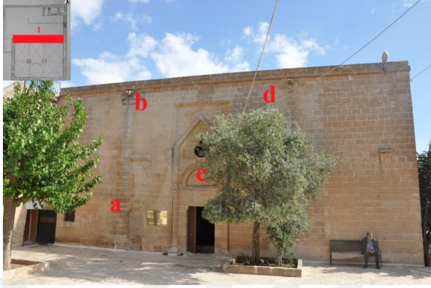
Şekil 4.288. Cami avluya bakan kuzey cephesindeki duvarlarda bozulmalar
