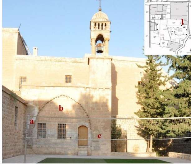
Şekil 4.480.Yapının sokağa bakan doğu cephesindeki duvarlarda oluşan bozulmalar
