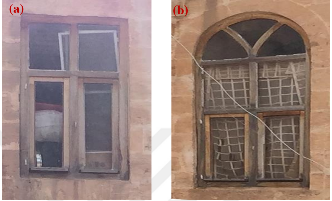
Şekil 4.387. 17-18 nolu ahşap pencerelerde çatlak, aşınma, renk değişimi(a), 21 nolu ahşap pencerede çatlak, aşınma, renk değişimi(b)
