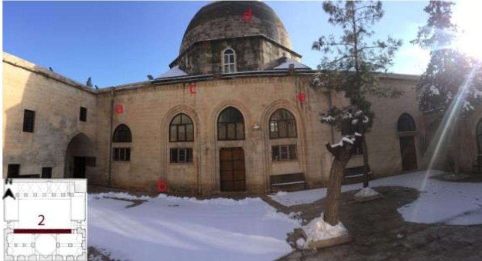
Şekil 4.114. 2 numaralı duvarlarda bozulmalar
