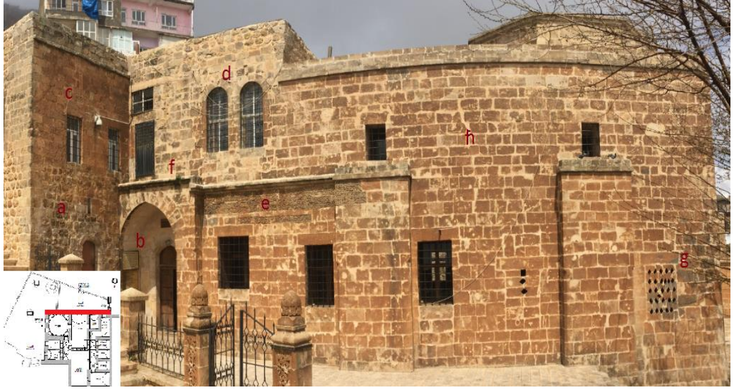
Şekil 4.315. Yapının güney cephesindeki duvarlarda bozulmalar
