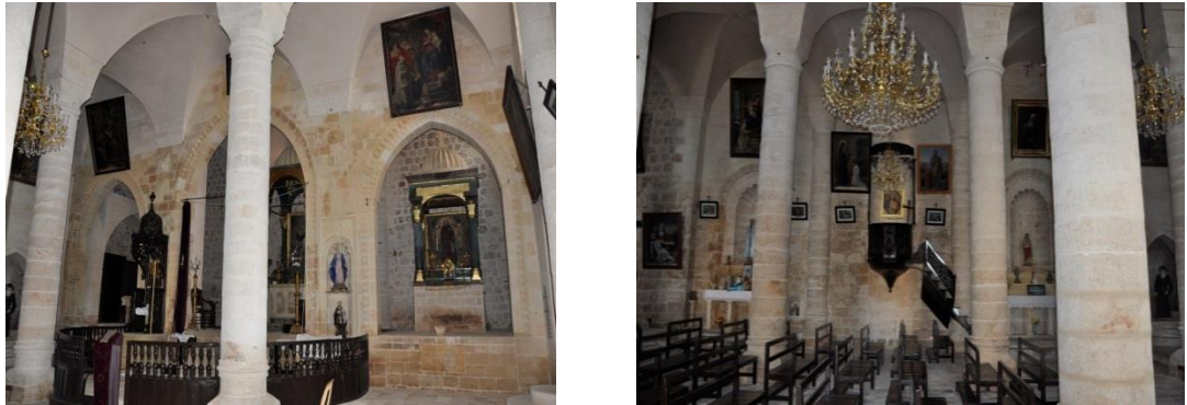
řekil 4.505. Kilisede i mekndaki tm duvarlarda renk deđiřimi, hatalı onarım
