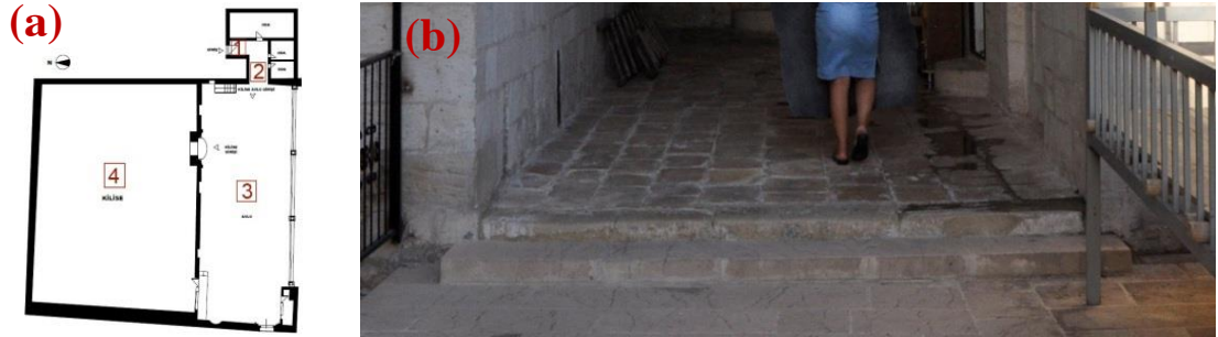
Şekil 4.509. Mekân numaraları(a), 2 numaralı mekânda merdivende aşınma(b)
