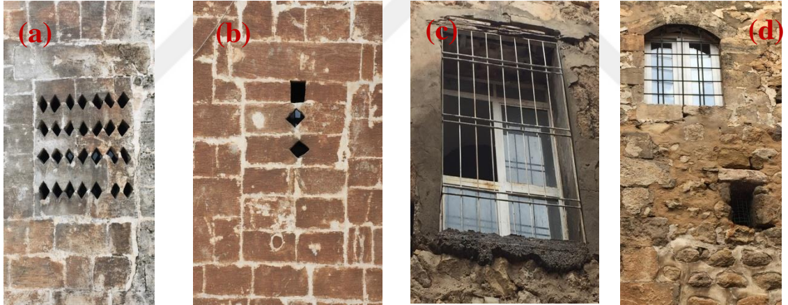
Şekil 4.336. Dışlıkta renk değişimi(a),dışlıkta çimento kullanımı(b),hatalı onarım(c) hatalı onarım(d)
