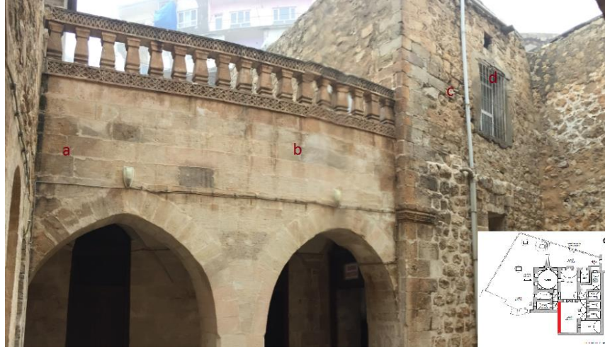
Şekil 4.324. Renk deęiřimi(a), çiçeklenme(b), derz boşalması(c), çimento kullanımı(d)
