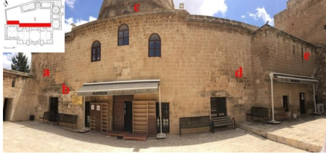
Şekil 4.57. Cami avluya bakan kuzey cephesindeki duvarlarda bozulmalar
