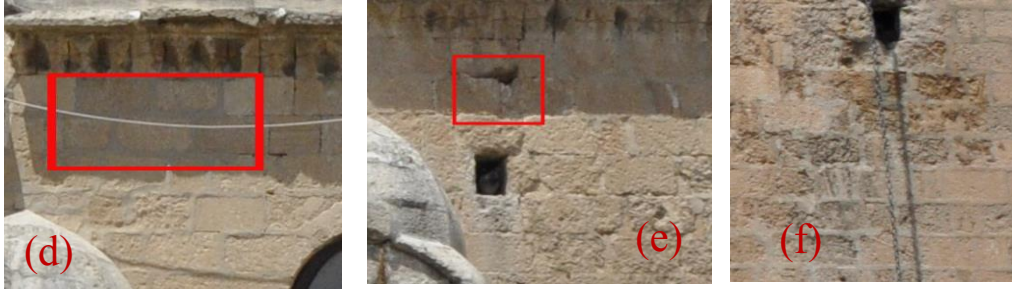
Şekil 4.63. Çimento kullanımı(d), derz boşalması(e), çimento kullanımı ve renk değişimi(f)
