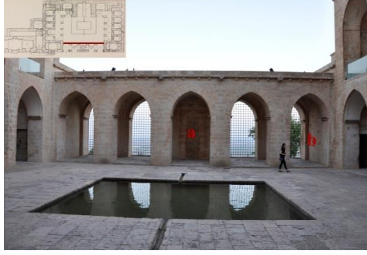
Şekil 4.455. Yapı avlu güney cephesindeki duvarlarda oluşan bozulmalar
