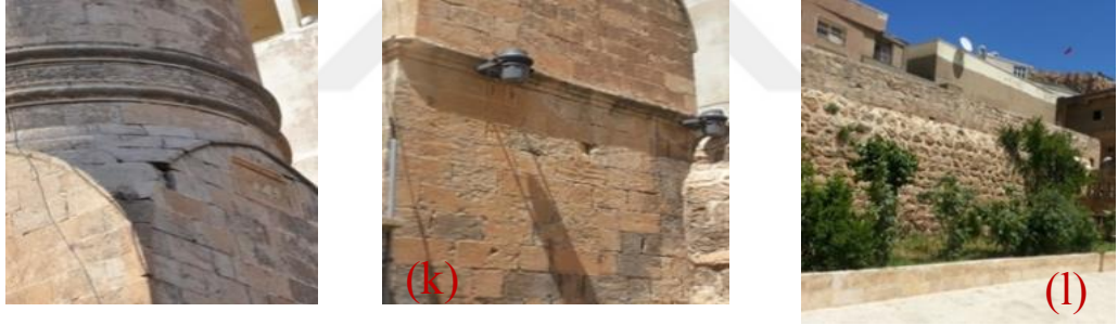
Şekil 4.121. Parça kaybı(j), yüzey kaybı(k), bitki oluşumu(l)
