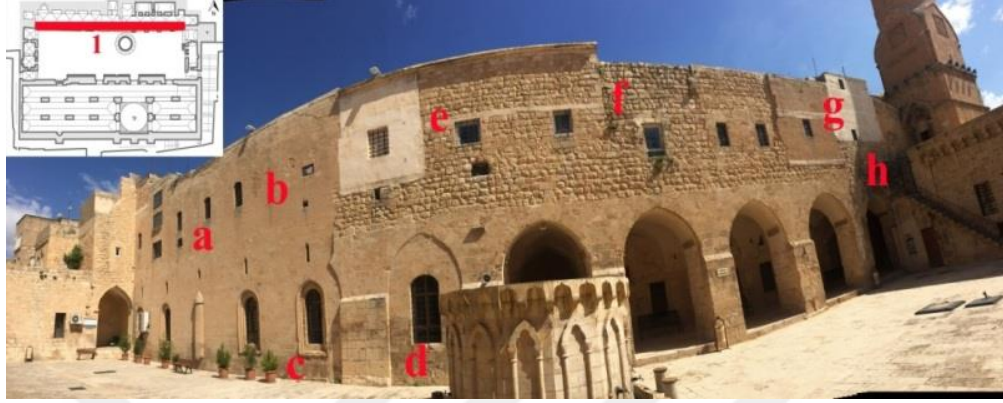
Şekil 4.17. Cami avluya bakan kuzey cephesindeki duvarlarda bozulmalar
