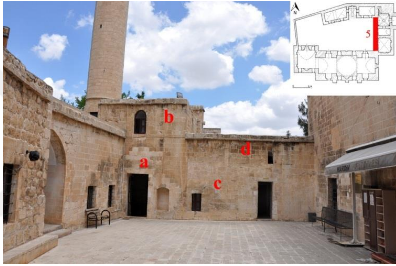
Şekil 4.72. Avluya bakan batı cephesindeki duvarlarda oluşan bozulmalar
