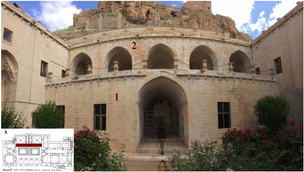
Şekil 4.407. Avlu güney cephesindeki duvarlarda bozulmalar
