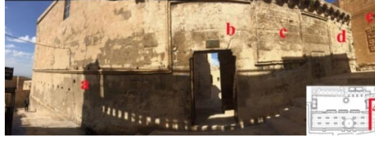
Şekil 4.24. Yapının sokağa bakan doğu cephesindeki duvarlarda oluşan bozulmalar
