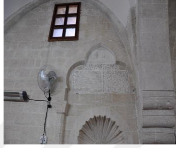
Şekil 4.266. İç mekânda duvarda yazılarda form kaybı
