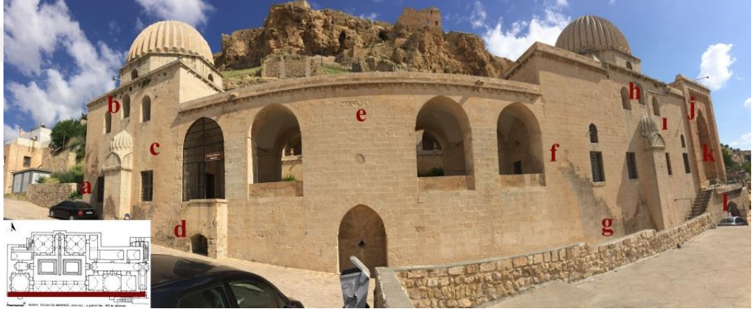
Şekil 4.409. Yapının doğu cephesindeki duvarlarda oluşan bozulmalar
