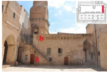
Şekil 4.27. Ulu Cami doğu cephesindeki duvarlarda oluşan bozulmalar
