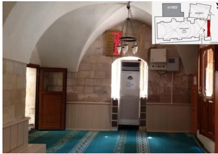
Şekil 4.218. Hatalı onarım(çimento kullanımı)
