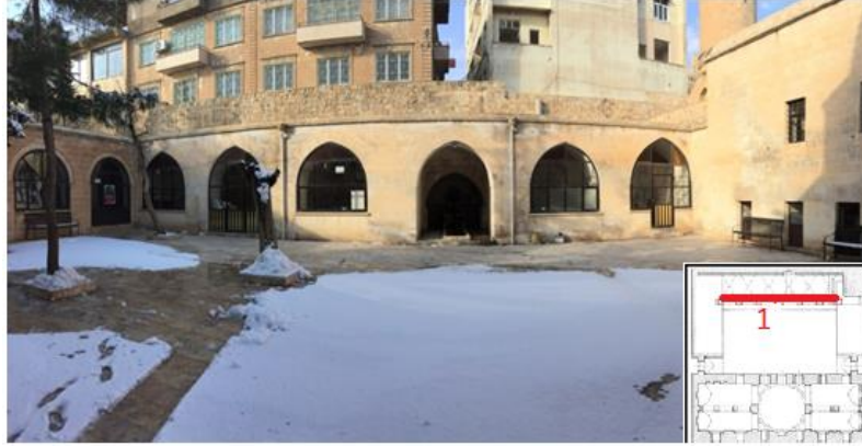
Şekil 4.138. Latifiye cami kuzey cephesindeki pencere ve kapılar
