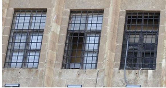
Şekil 4.513. 5-6-7 numaralı ahşap pencerelerde çatlak-kırık, aşınma, renk değişimi
