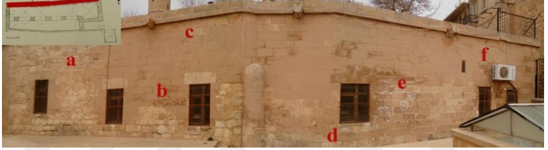
Şekil 4.171. Cami avluya bakan kuzey cephesindeki duvarlarda bozulmalar
