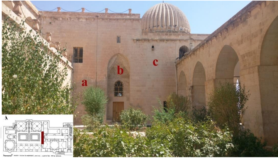
Şekil 4.418. Avlu batı cephesi(5 numaralı cephe) malzeme bozulmaları
