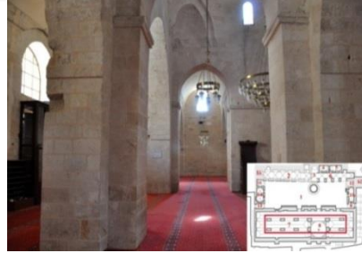
Şekil 4.16. Ulu Camii'nde iç mekândaki ayaklarda oyuklanma
