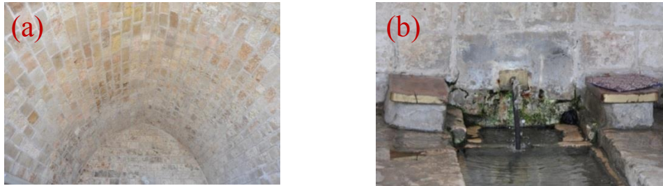
Şekil 4.199. 3 numaralı mekânda sivri tonozda renk değişimi, çimento kullanımı(a), 3 numaralı mekânda düz döşemede yosun oluşumu(b)
