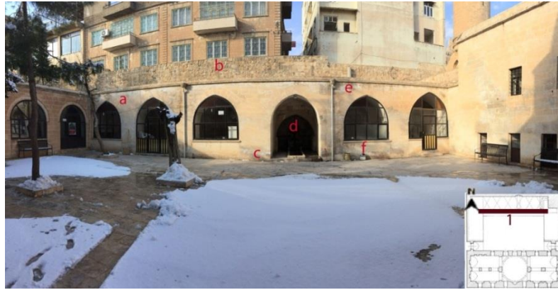
Şekil 4.111. 1 numaralı duvarlarda oluşan bozulmalar
