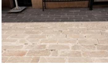
Şekil 4.80. 3 numaralı mekânda düz döşemede derz boşalması
