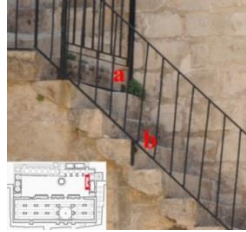
Şekil 4.37. Merdivende bitki oluşumu(a), aşınma (b)
