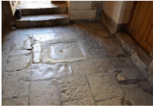
Şekil 4.422. 2 numaralı mekânda düz döşemede aşınma
