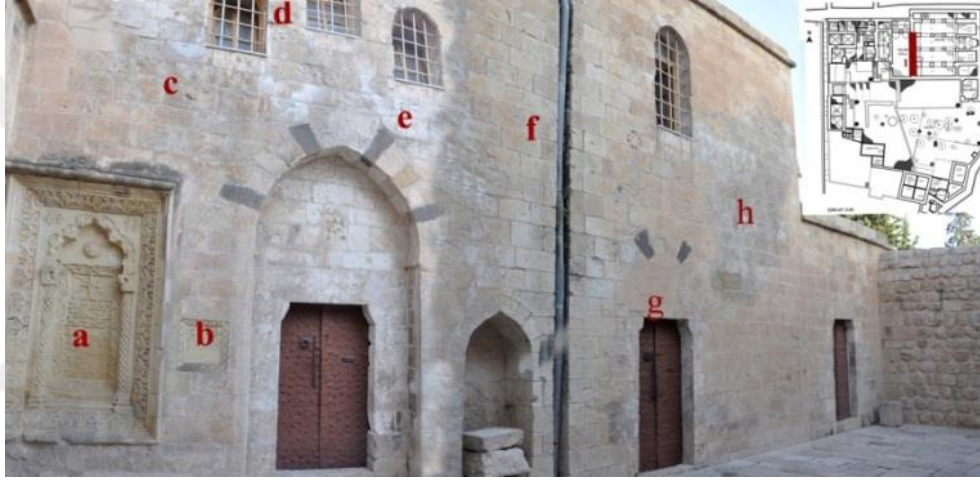
Şekil 4.475. Cami avluya bakan kuzey cephesindeki duvarlarda bozulmalar
