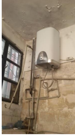
Şekil 4.219. Abdesthane(2 numaralı mekân) duvarlarında çimento kullanımı(hatalı onarım)
