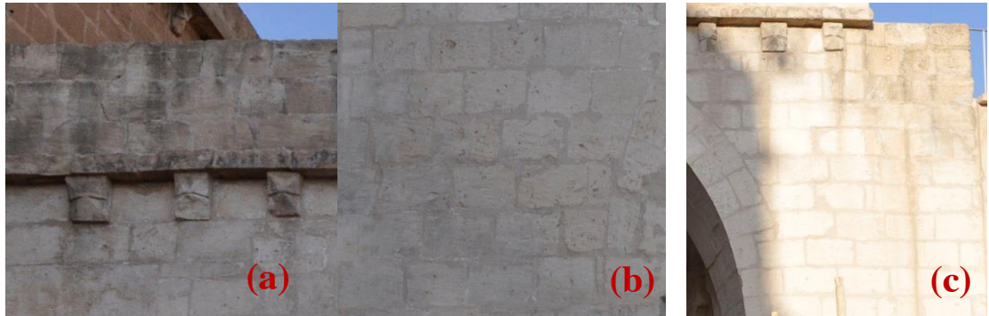
Şekil 4.503. Renk deęiřimi(a),hatalı onarım(b),yüzey kirlilięi(c)
