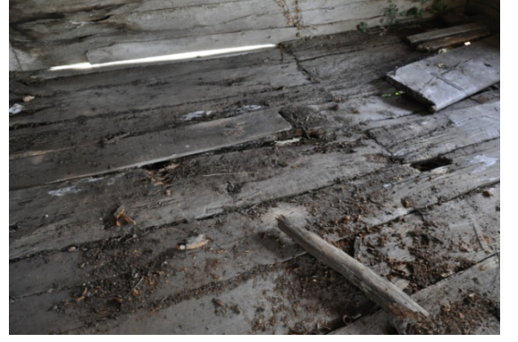
Şekil 4.429. Kuşhane Köyü Camii ahşap döşemelerde görülen deformasyon (Aydın 2016)
