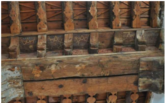
Şekil 4.174. Afyon Ulu Camii deforme olan kalem işi örneği (Aydın 2015)
