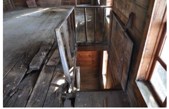
Şekil 4.391. Beldeğirmen Köyü Camii mahfile çıkışta görülen deformasyon örneği (Aydın 2014)
