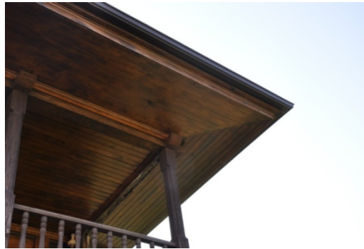
Şekil 4.699. Hüseyin Hoca Camii çatı saçığı (Aydın 2016)
