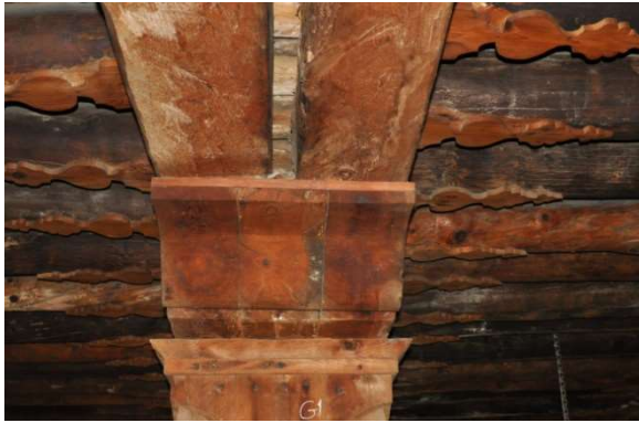
Şekil 4.180. Afyon Ulu Camii deforme olan dikme örneği (Aydın 2015)
