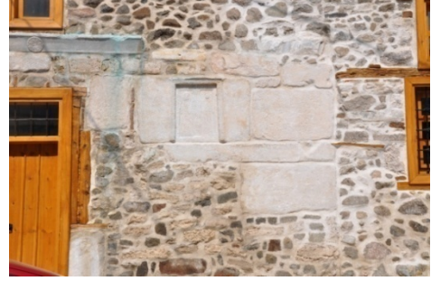
Şekil 4.51. Sivrihisar Ulu Camii doğu cephesi devşirme malzeme örneği (Aydın 2015)
