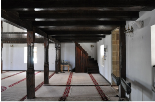
Şekil 4.770. Zeytinlik Köyü Camii dikme görünümü (Aydın 2016)
