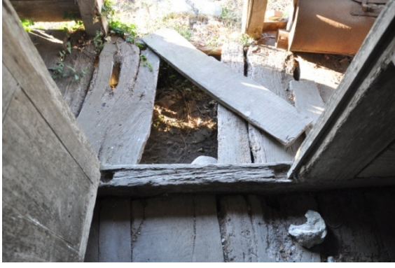
Şekil 4.428. Kuşhane Köyü Camii ahşap döşemelerde görülen deformasyon (Aydın 2016)
