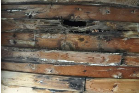
Şekil 4.396. Beldeğirmen Köyü Camii deformasyon örneği (Aydın 2014)
