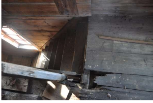
Şekil 4.394. Beldeğirmen Köyü Camii mahfil zemininde görülen deformasyon örneği (Aydın 2014)
