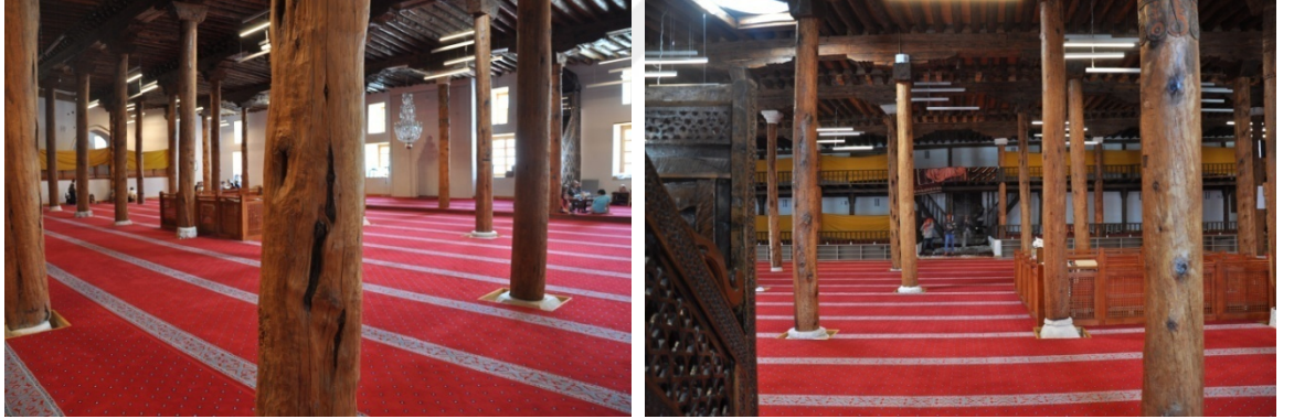
Şekil 4.82. Sivrihisar Ulu Camii dikmede oluşan deformasyon(Aydın 2015)
