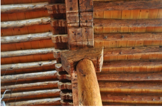
Şekil 4.90. Sivrihisar Ulu Camii dikme başlığında oluşan bozulmalar(Aydın 2015)
