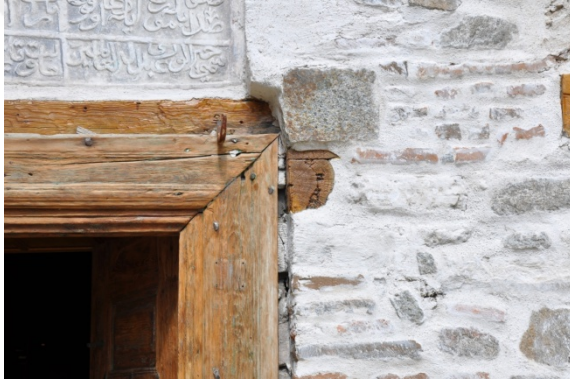
Şekil 4.53. Sivrihisar Ulu Camii doğu cephesi kapı görünümü deformasyon örneği(Aydın 2015)
