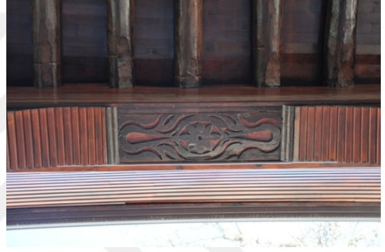
Şekil 4.271. Sille Çay Camii son cemaat bölümü ahşap dikme payandaları (Aydın 2015)
