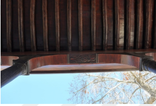
Şekil 4.270. Sille Çay Camii son cemaat bölümü ahşap dikme payandaları (Aydın 2015)
