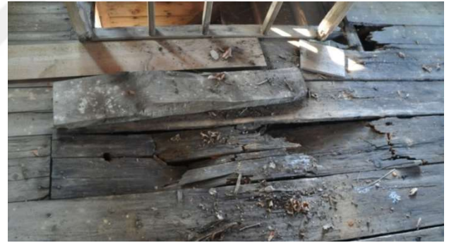
Şekil 4.393. Beldeğirmen Köyü Camii mahfil zemininde görülen deformasyon örneği (Aydın 2014)
