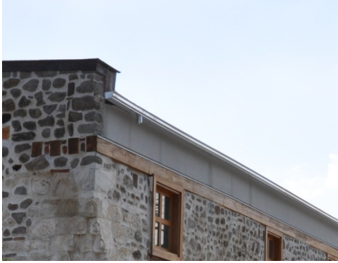
Şekil 4.45. Sivrihisar Ulu Camii güney cephesi restorasyon sonrası eklenen oluk görünümü(Aydın 2015)
