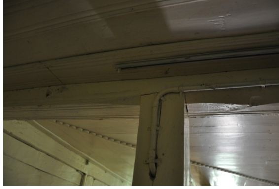
Şekil 4.585. Serindere Camii dikme başlığı deformasyon örneği (Aydın 2016)
