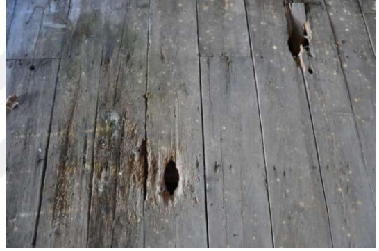
Şekil 4.397. Beldeğirmen Köyü Camii deformasyon örneği (Aydın 2014)
