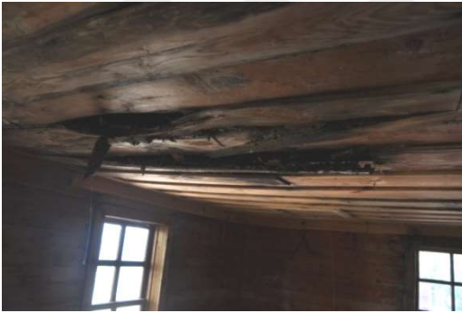
Şekil 4.392. Beldeğirmen Köyü Camii mahfile çıkışta görülen deformasyon örneği (Aydın 2014)
