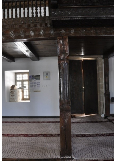
Şekil 4.772. Zeytinlik Köyü Camii dikme görünümü (Aydın 2016)
