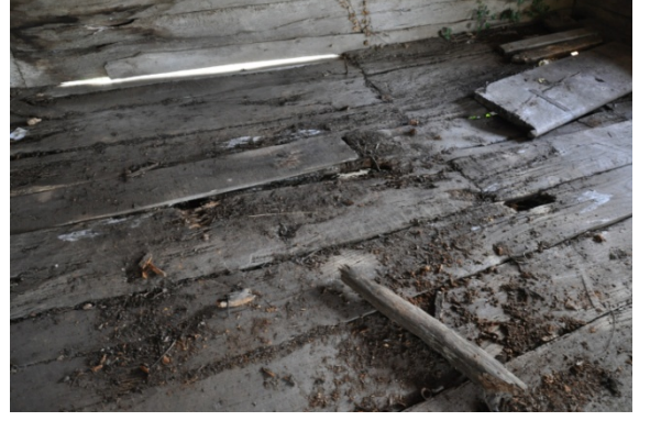
Şekil 4.425. Kuşhane Köyü Camii zemininde görülen deformasyon örneği (Aydın 2016)
