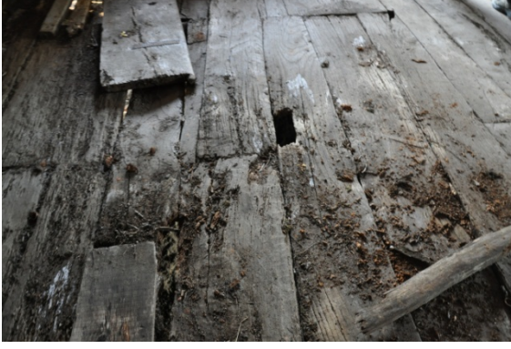
Şekil 4.424. Kuşhane Köyü Camii zemininde görülen deformasyon örneği (Aydın 2016)
