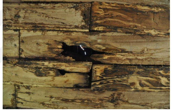
Şekil 4.499. Kargılı Camii ahşap tavanda görülen deformasyon (Aydın 2016)
