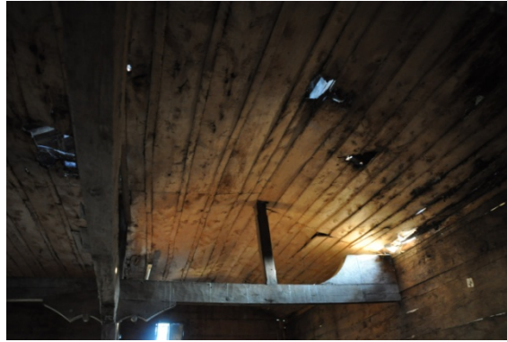
Şekil 4.423. Kuşhane Köyü Camii tavanında görülen deformasyon (Aydın 2016)
