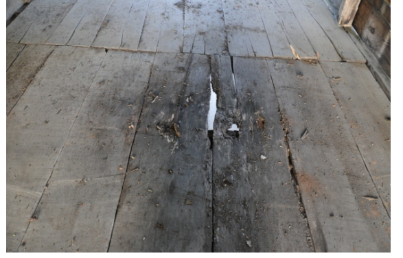
Şekil 4.497. Kargılı Camii mahfil döşemelerinde görülen deformasyon (Aydın 2016)
