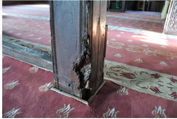
Şekil 4.714. Hüseyin Hoca Camii taşıyıcı dikmede görülen bozulma örneği (Aydın 2016)
