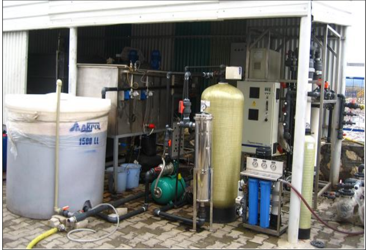
Şekil 3.5. Pilot ölçekli zeytin karasuyu arıtma tesisinin genel görünümü
