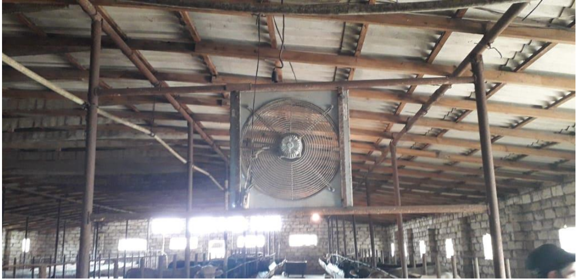
Şekil 2.1. Barınaklarda uygulanan mekanik havalandırma örneği
