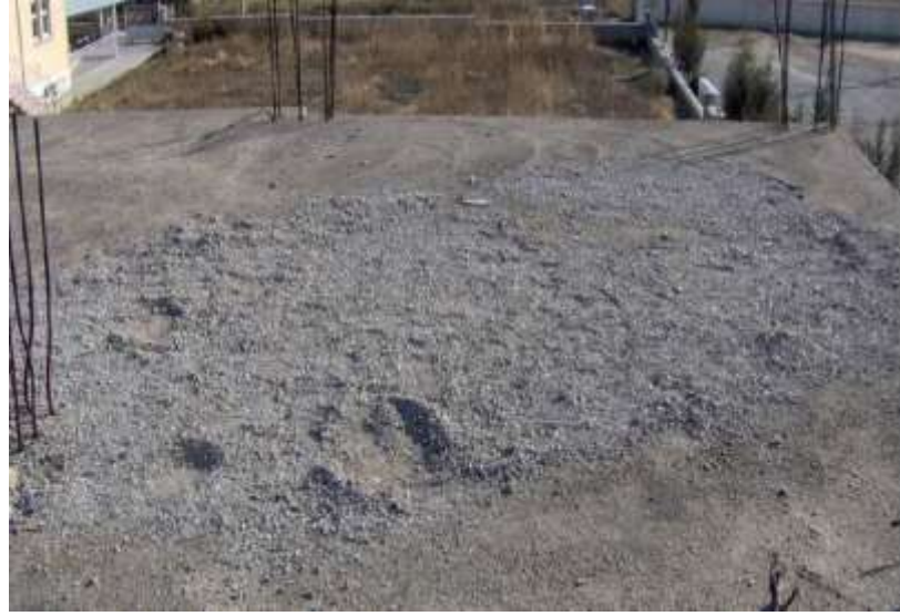
Őekil 2.11. Donma-zlme evrimi sonrası hasar gren Denizli ili - Iřıklı ilesi betonarme dřeme (Baradan ve ark. 2002)
