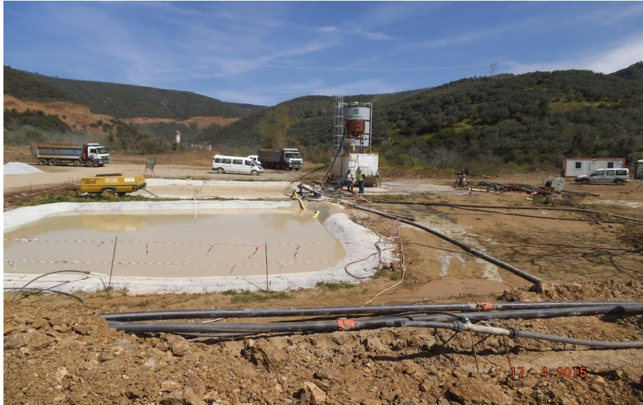
Şekil 3.27. Bentonit işleme tesisi
