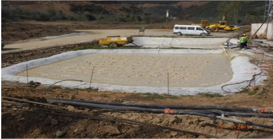
Şekil 3.28. Bentonit dinlendirme havuzu ve hava sirkülasyonu
