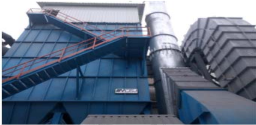
Şekil 4.16. Filtre sistemi genel görünümü
