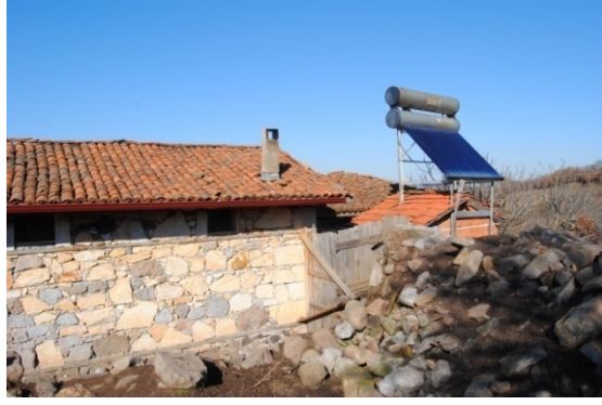
Şekil 4.16. Ekolojik yerleşkede sıcak su için kullanılan güneş enerji paneli (Bartu 2019-2020 arşivinden alınmıştır)
