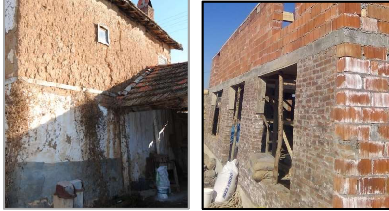
Şekil 4.25. Ahmetçeli hımış konut yapısı ve Sevinç Abla tuğla yığma atölye yapısı (Bartu 2019-2020 arşivinden alınmıştır)
