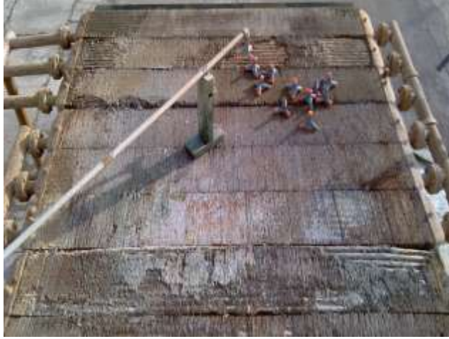
Şekil 3.17. Su Püskürtme Sonucu Oluşan Korozif Etki
