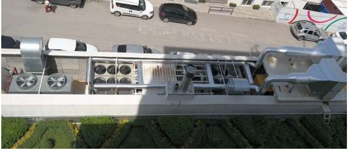
Şekil 3.27. Evaporatif Soğutma Sistemi
