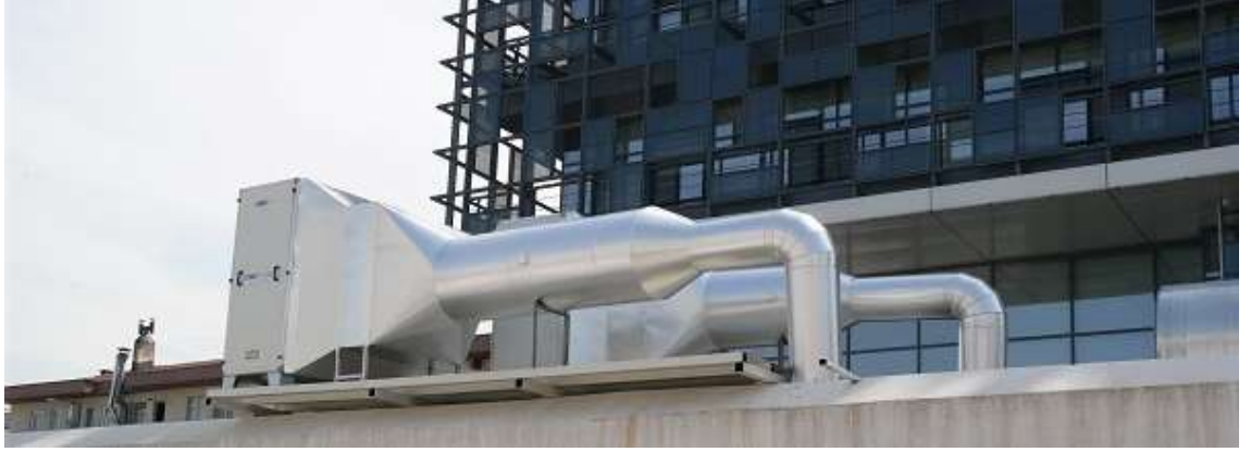
Şekil 3.28. Evaporatif Soğutma Sistemi
