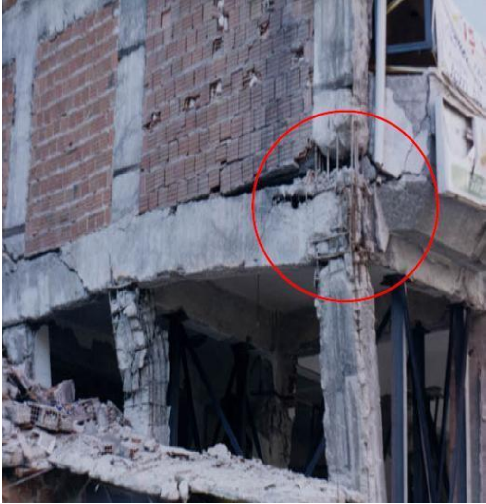
Şekil 1.3. Kolon-kiriş birleşim bölgesi deprem hasarı ve birleşim bölgesindeki soğuk derz (Anonim 2009)
