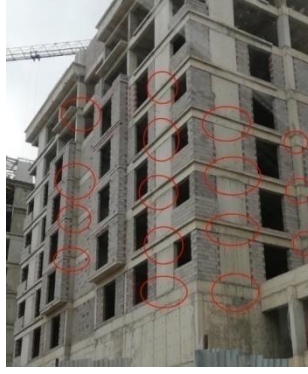
Şekil 1.5. Betonarme bir yapıda imalat sırasında oluşan soğuk derzler
