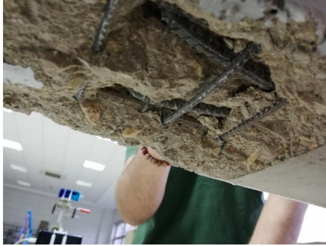
Şekil 4.26. Kirişin alt kısmında kabuk betonunun dökülmesi
