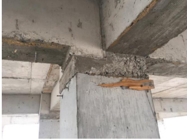
Şekil 1.1. Kolon-kiriş birleşin bölgesinde bırakılan soğuk derz (Ölmez 2019)
