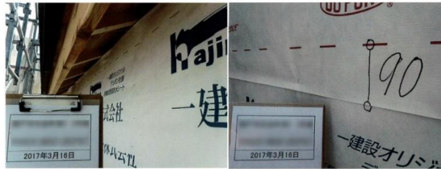
Şekil 3.52. Japonya örneği, dış duvar nem bariyeri uygulaması (Anonim 2017)
