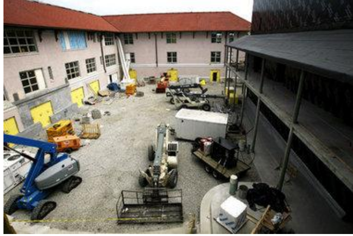
Şekil 2.40. Andrew H. Wilson İlkokulu yenileme sırasında Rusty Costanza tarafından çekilen avlu fotoğrafı ( http://www.nola.com/opinions/index.ssf/2011/08/review_new_orleans_school_mast.html , 2014)
