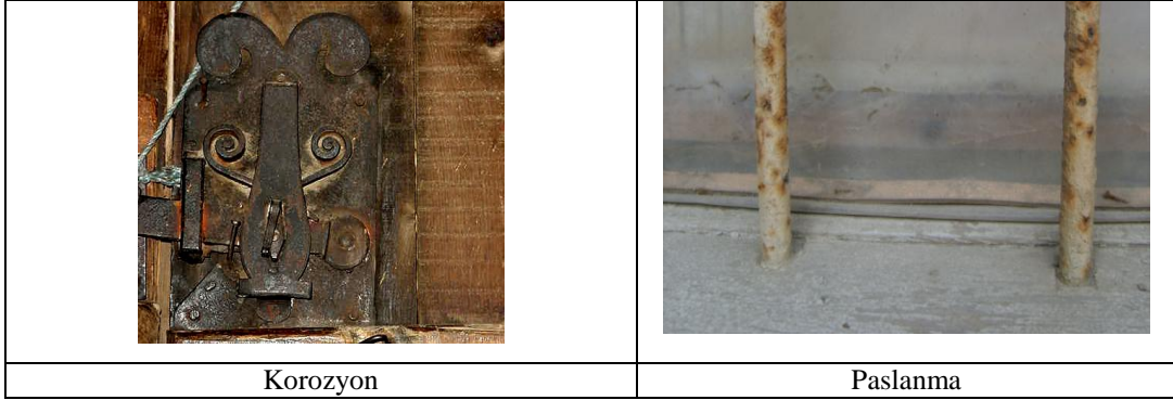
Çizelge 2.22. Metal Malzemede Görülen Bozulmalardan Örnekler
