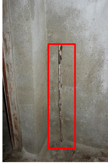
Şekil 6.71. Z03 koridor duvarında demir kılıç
