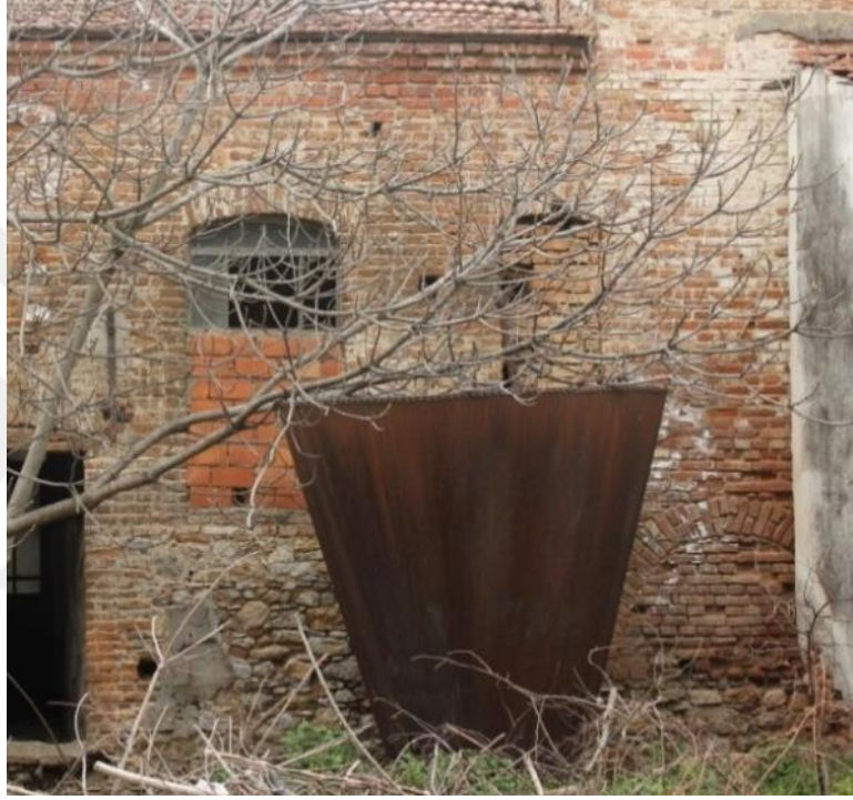
Şekil 6.31. Bahçede bulunan ve buhar kazanına su gönderen soğuk su tankı
