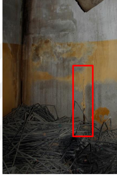
Şekil 6.70. Z02 mutfak duvarında demir kılıç
