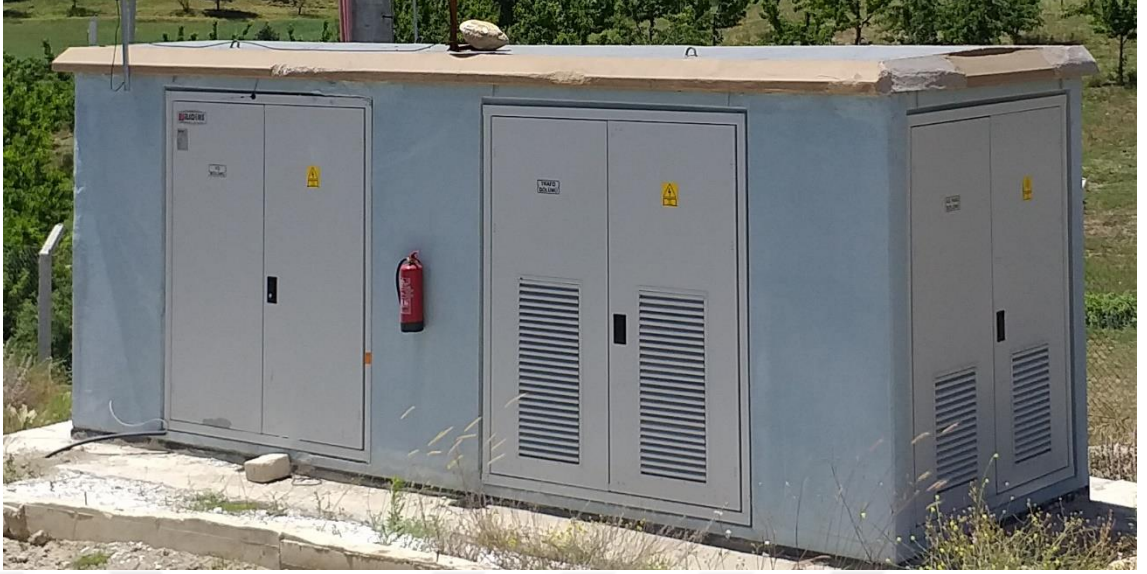
Güneş enerji santralinin trafo merkezi
