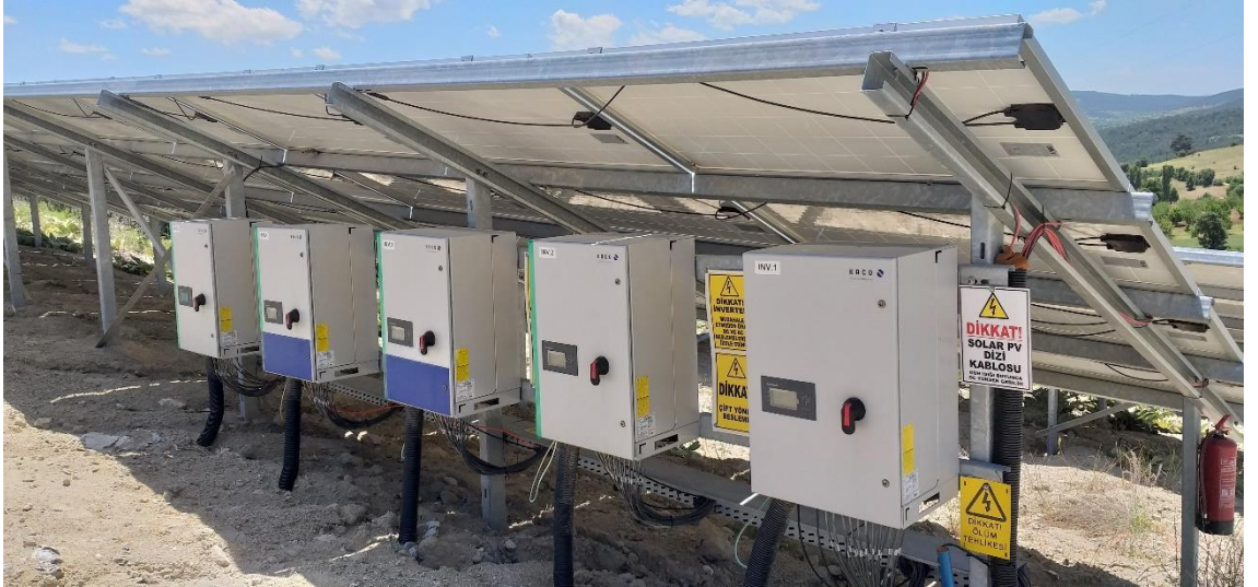
G6neş enerji santralinin invert6rleri
