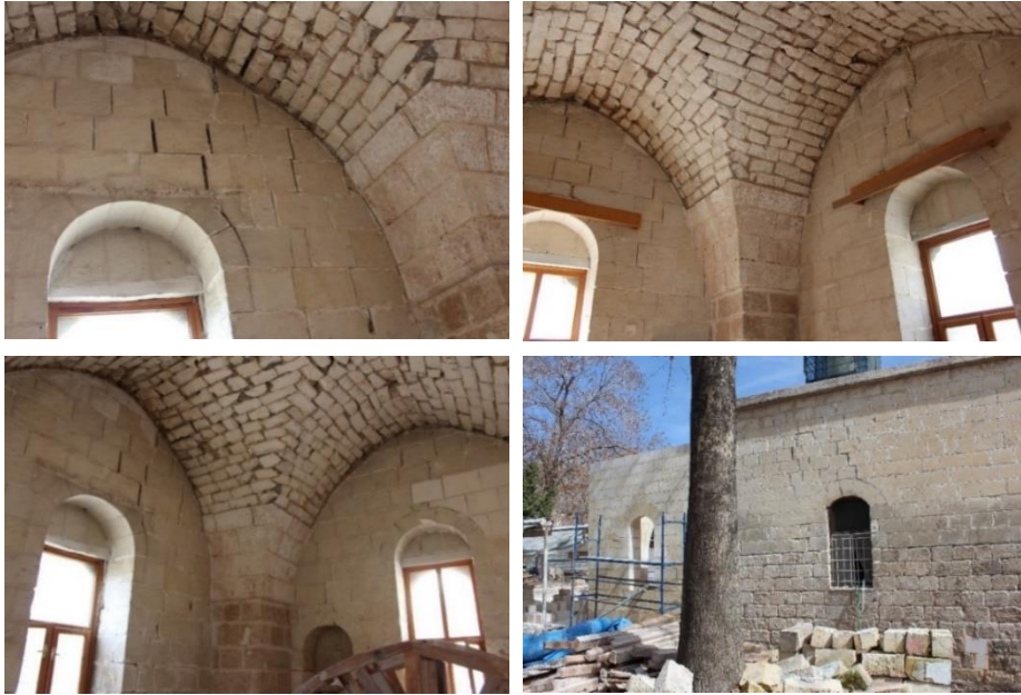
Şekil 3: Beden duvarlarındaki açılmalar
