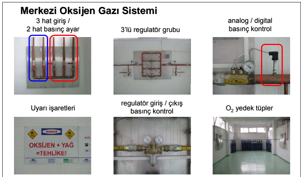
Şekil 3.2 – Merkezi Oksijen Sisteminde bazı unsurlar
