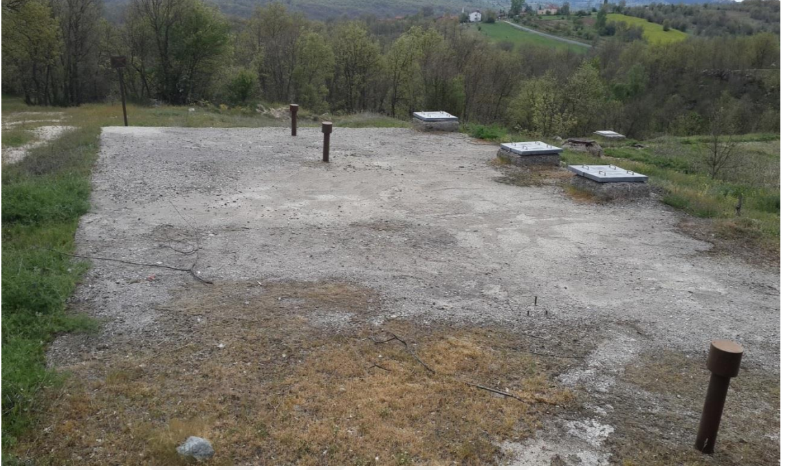
Şekil 4.35. Pınar Doğal Arıtma Yapısı (Fosseptik Yapısı)
