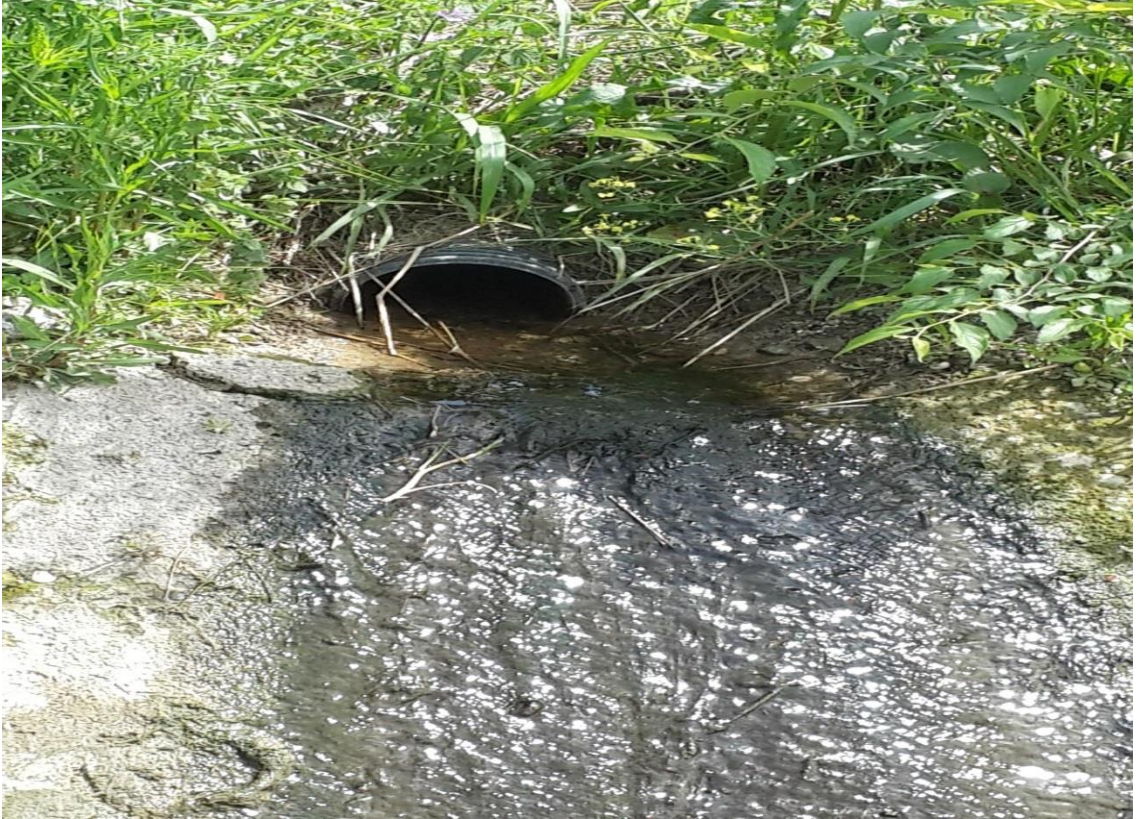
Şekil 4.8. Çiçekli Doğal Arıtma Tesisi Çıkış Yapısı
