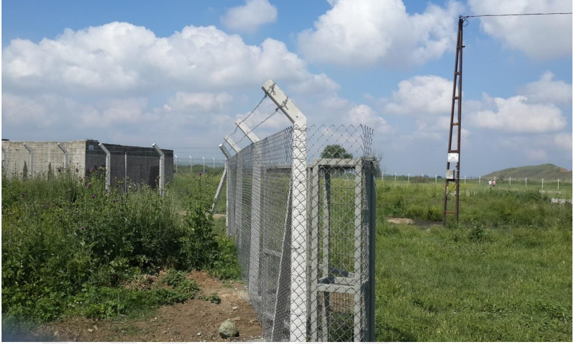
Şekil 4.7. Ocaklı Doğal Arıtma Tesisi
