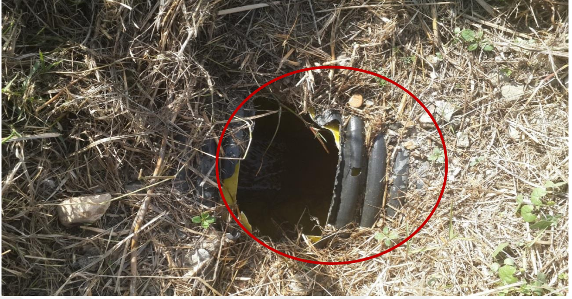
Şekil 4.24. Çiçekli Doğal Arıtma Tesisi giriş yapısına yakın örnek alınan kırık boru
