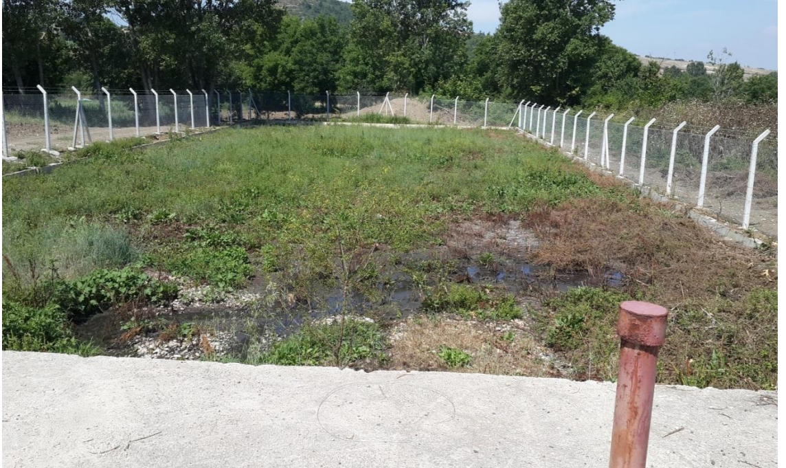
Şekil 4.42. İncirli Doğal Arıtma Tesisi (Yüzey Altı Akış Yapısı)
