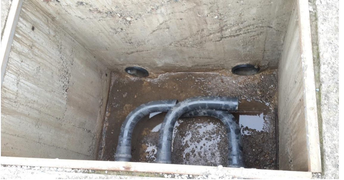
Şekil 4.5. Ocaklı Doğal Arıtma Tesisi çıkış yapısı
