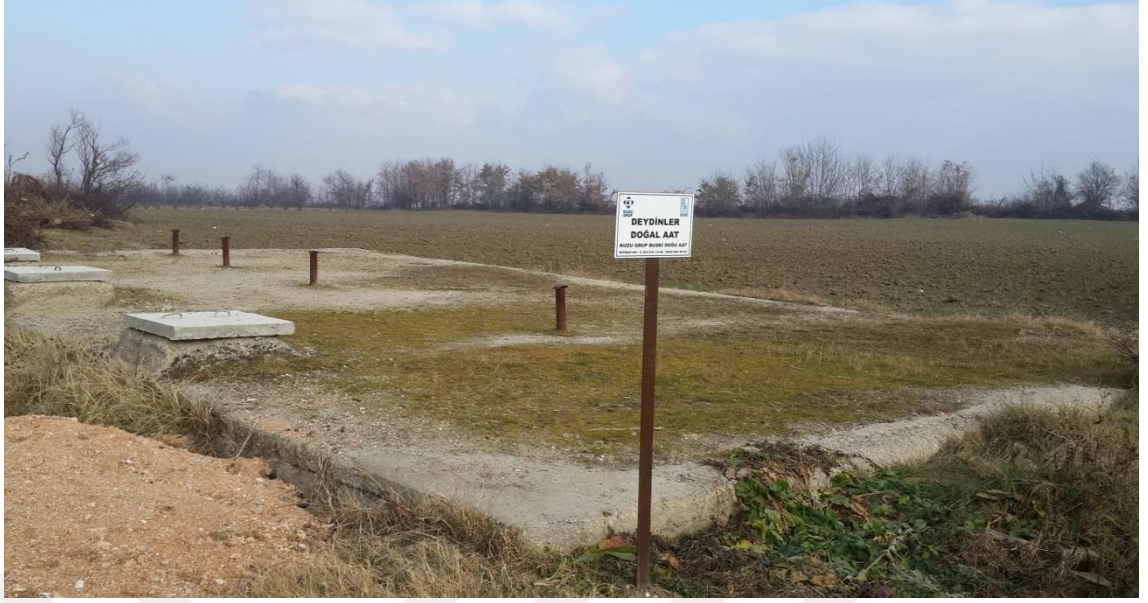
Şekil 4.61. Deydinler Doğal Arıtma Tesisi (Fosseptik Yapısı)
