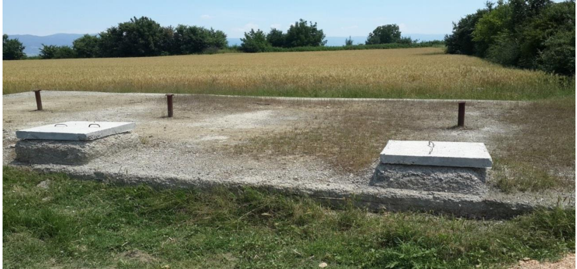
Şekil 4.64. Deydinler Doğal Arıtma Tesisi (Giriş Yapısı)
