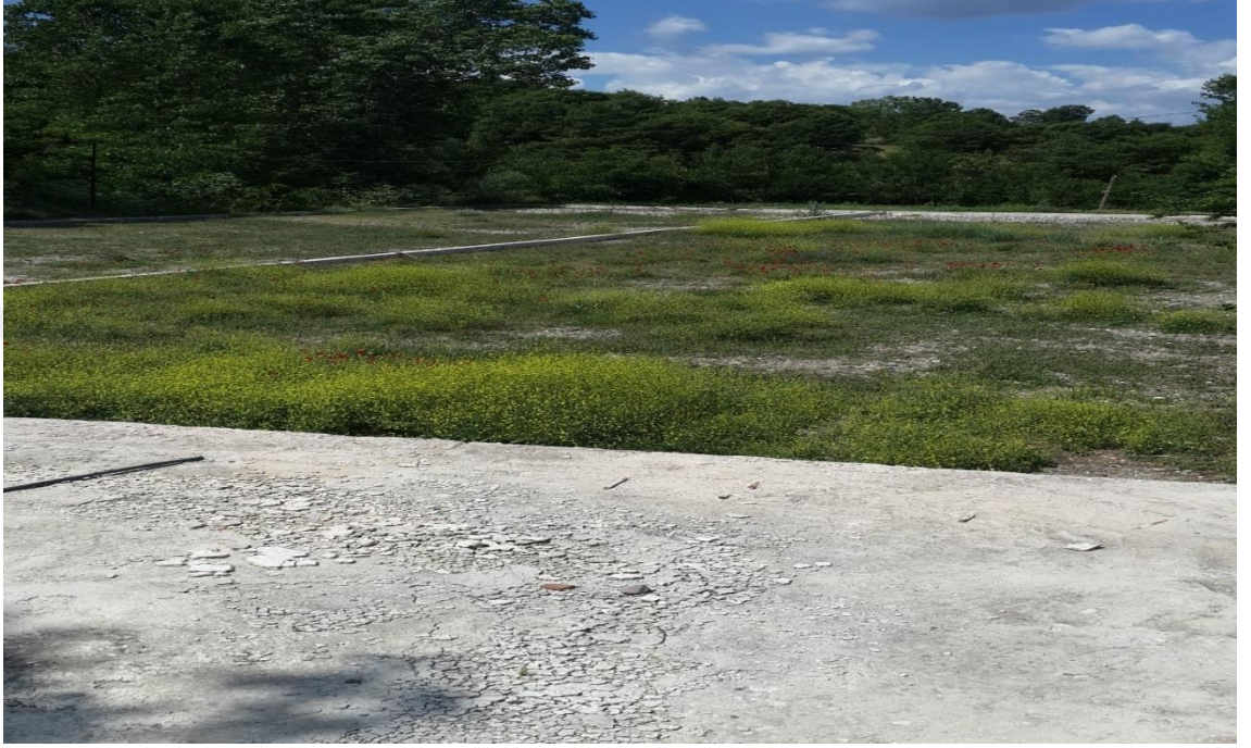
Şekil 4.31. Büyükorhan Yenice Doğal Arıtma Tesisi (Yüzey Altı Akış Yapısı)
