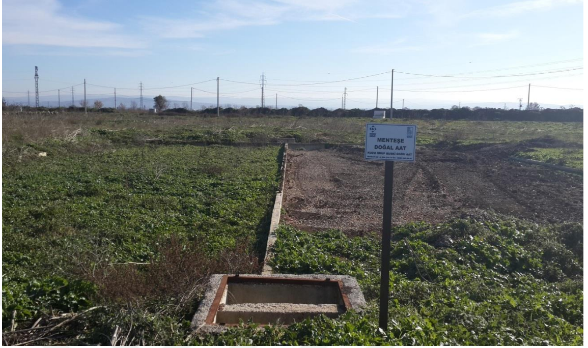
Şekil 4.13. Mentese Doğal Arıtma Tesisi
