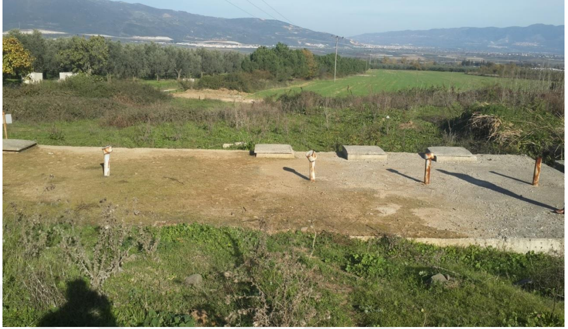
Şekil 4.36. Gürle Doğal Arıtma Tesisi (Foseptik Yapısı)
