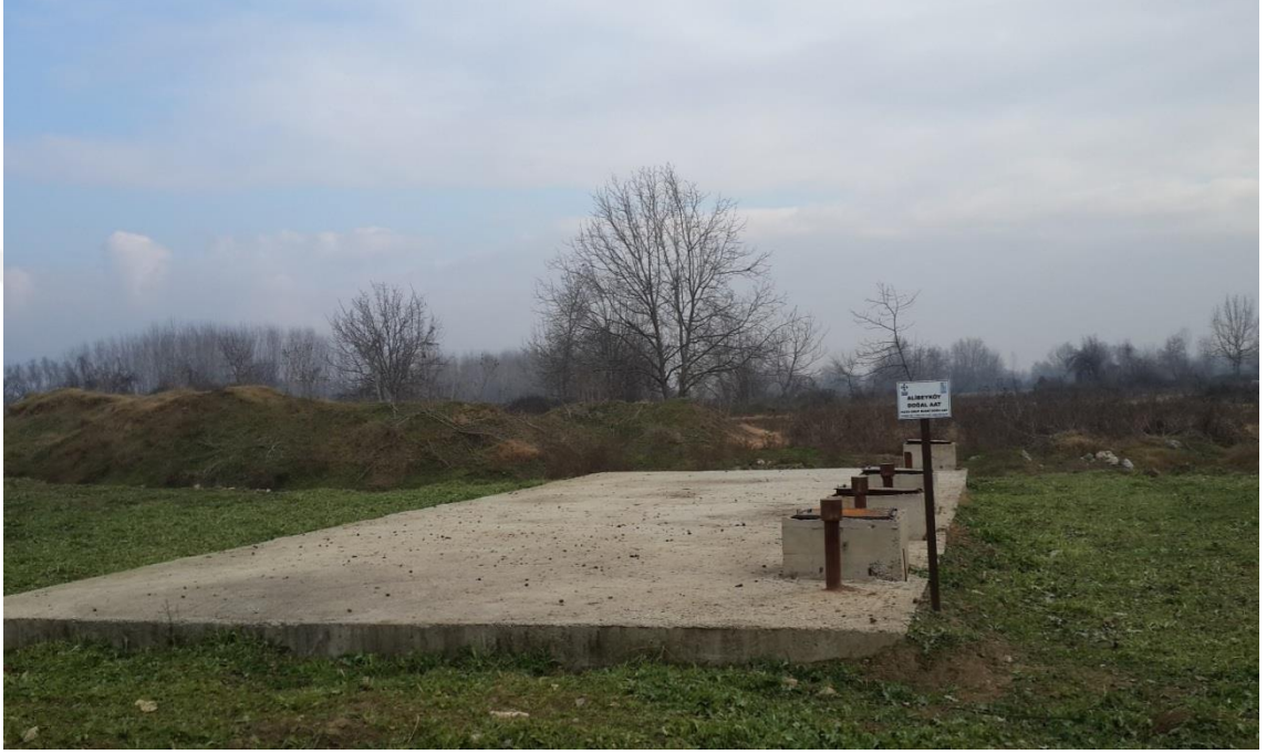
Şekil 4.60. Deydinler Doğal Arıtma Tesisi (Foseptik Yapısı)
