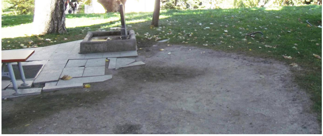
Şekil 4.290. Yeşil türbe bahçesi kuzeyinde yer alan hasarlı ve özensiz döşeme (Fotoğraf: Gülşah MERCAN 2016)
