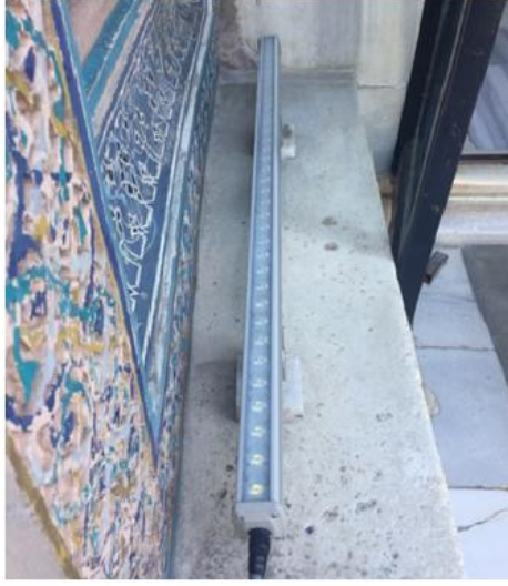
Şekil 4.258. Türbe cephesini aydınlatma amacıyla yerleştirilmiş led armatür (Fotoğraf: Gülşah MERCAN 2017)
