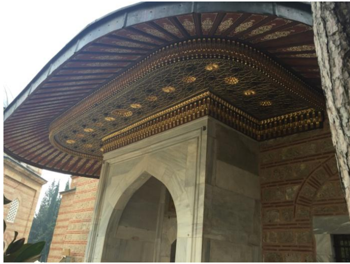
Şekil 4.304. II. Murad türbesine ait ahşap saçak (Fotoğraf: Gülşah MERCAN 2017)
