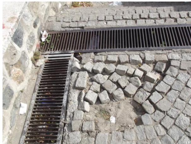
Şekil 4.289. Yeşil türbenin güney batısında yer alan yaya yoluna ait hasarlı döşeme (Fotoğraf: Gülşah MERCAN 2016)
