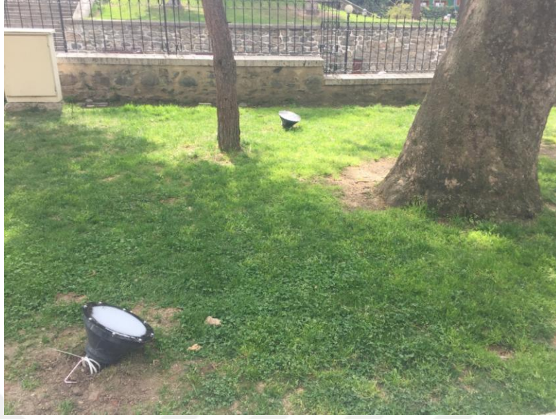
Şekil 4.266. Cami bahçesinde yer alan anıt ağaçları vurgulamak amacıyla kullanılan yere monte spot armatür (Fotoğraf: Gülşah MERCAN 2017)
