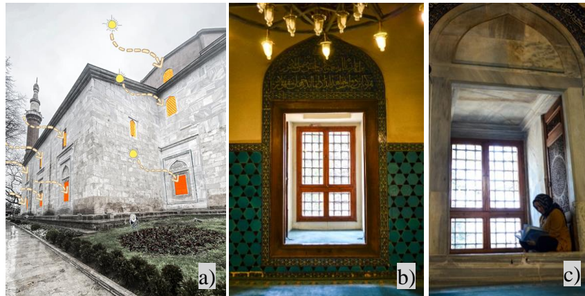
Şekil 3.51. Yeşil Cami pencereleri; a) gün ışığının üç farklı kotta yer alan pencereler sayesinde mekana alınması, b) zemin kat havalandırma ve aydınlatma amacı ile kullanılan pencere, c) duvar kalınlığından kaynaklı oluşan alanın değerlendirilmesi (Fotoğraf: Büşra Canbakış)
