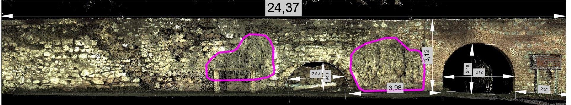
Resim 61: Lafke Kapı su kemerinde mevcut durum
