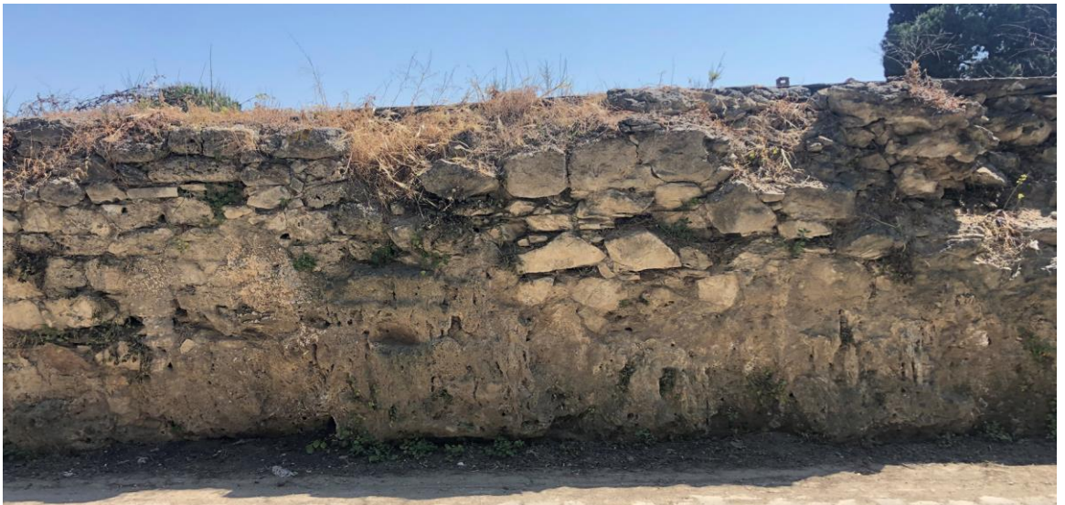
Resim 4: Su kemeri duvarlarındaki kireç tabakaları
