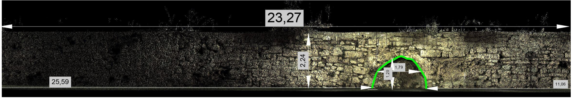
Resim 56: Lafke Kapı su kemerinde mevcut durum
