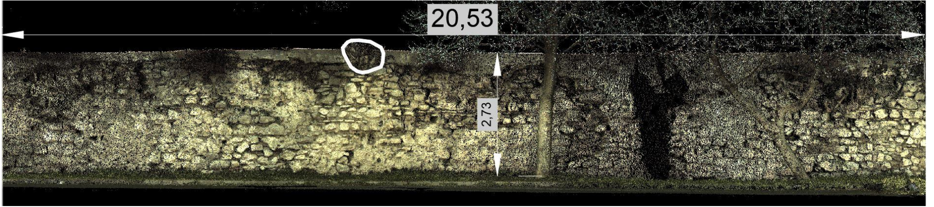
Resim 60: Lafke Kapı su kemerinde mevcut durum
