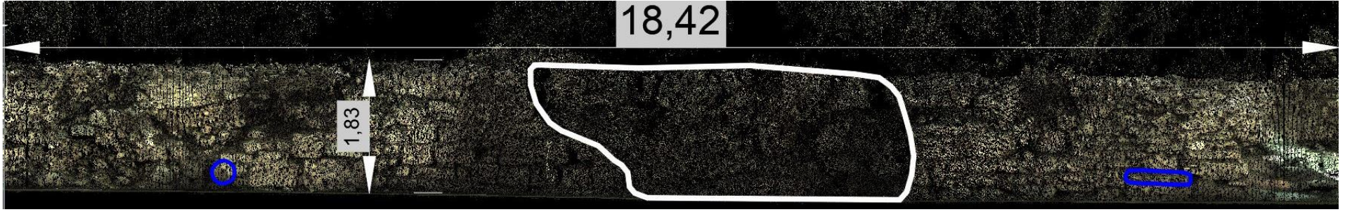
Resim 46: Lafke Kapı su kemerinde mevcut durum
