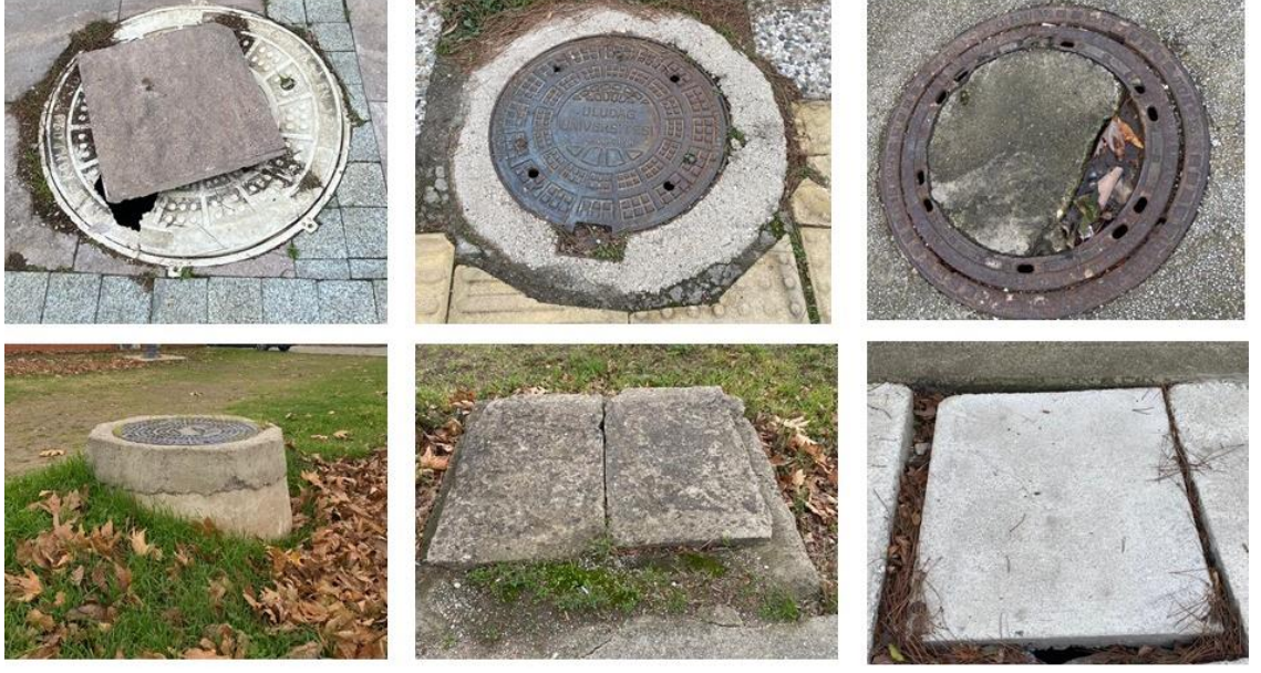
Şekil 4.40. Bursa Uludağ Üniversitesi Görükle Yerleşkesi'nde bulunan çeşitli altyapı tesisi kapakları (Orijinal)
