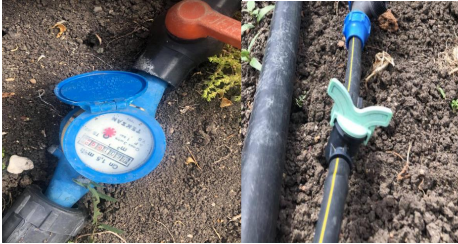
Şekil 3.4. Blok başına yerleştirilen su sayacı
