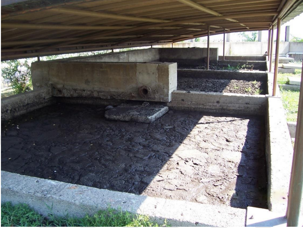
Şekil 3.8. Çamur kurutma yatakları genel görünümü
