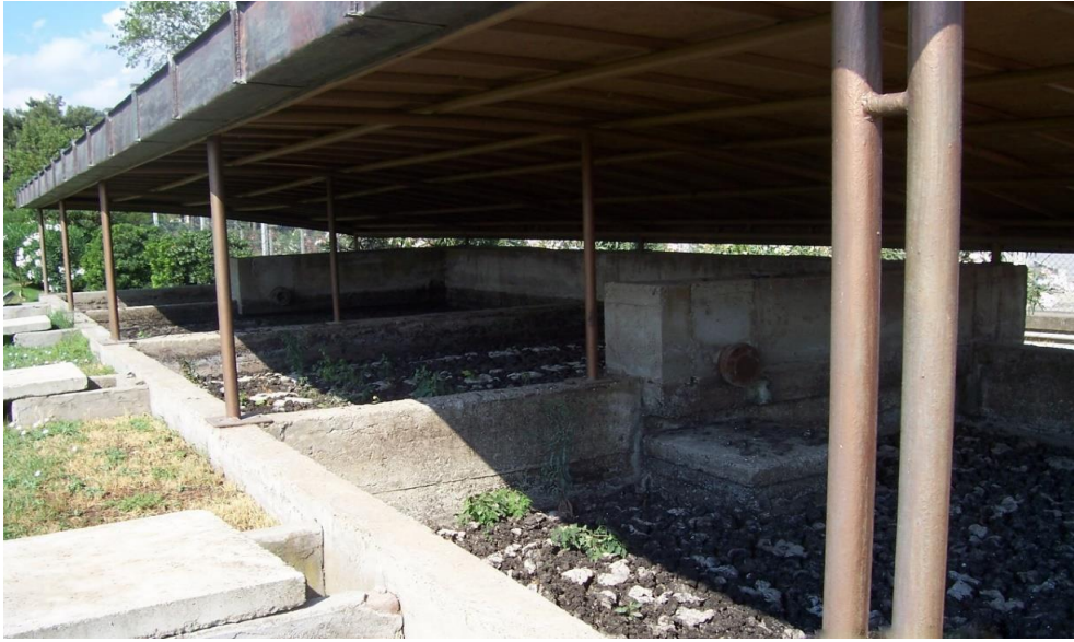
Şekil 3.9. Çamur kurutma yatakları genel görünümü
