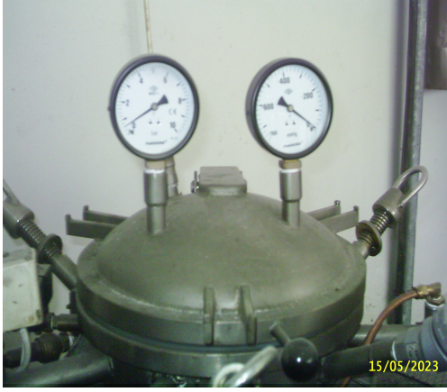
c. Buharlama makinasına ait vakummetre ve manometre
