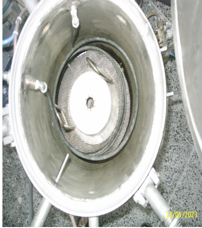
a. Vakumlu buhar kazanının iç görüntüsü
