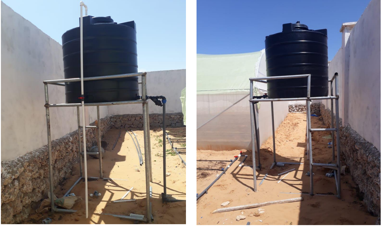
Şekil 3.9. Sulama sisteminde kullanılan su deposu ve ana boru bağlantısı
