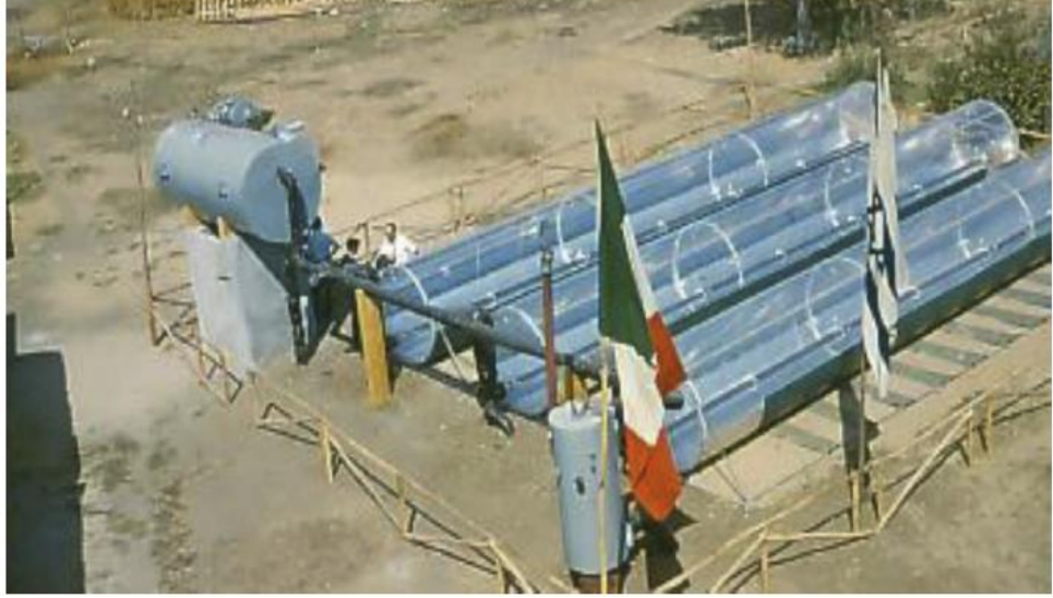
Şekil 2.8. Güneş kolektörlü, ısı depolu ve yedek kazanlı 3 kW'lık bir turbojeneratör (Bronicki, 2017)
