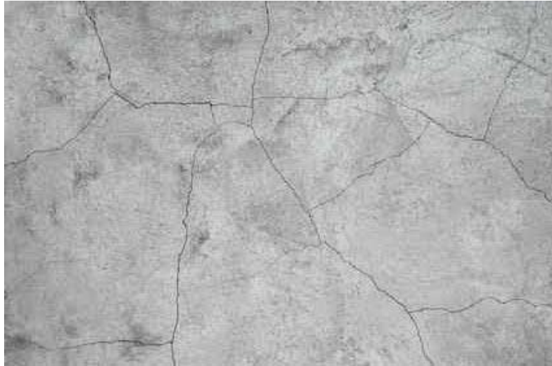
Şekil 2.1: Plastik Rötne Çatlakları
