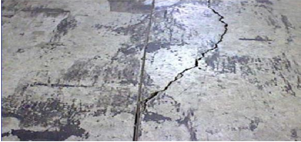
Şekil 2.2: Otopark zemin kaplamasında kuruma rötresi çatlakları (Kadioğlu, 2006)
