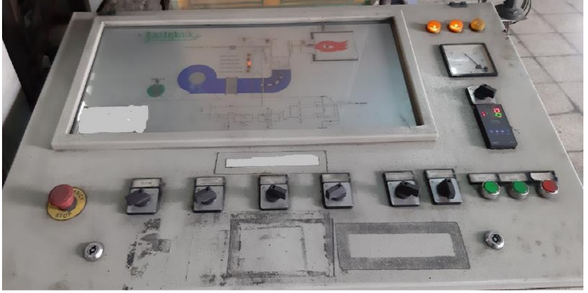
Şekil 3.15 Brülör kontrol paneli.
