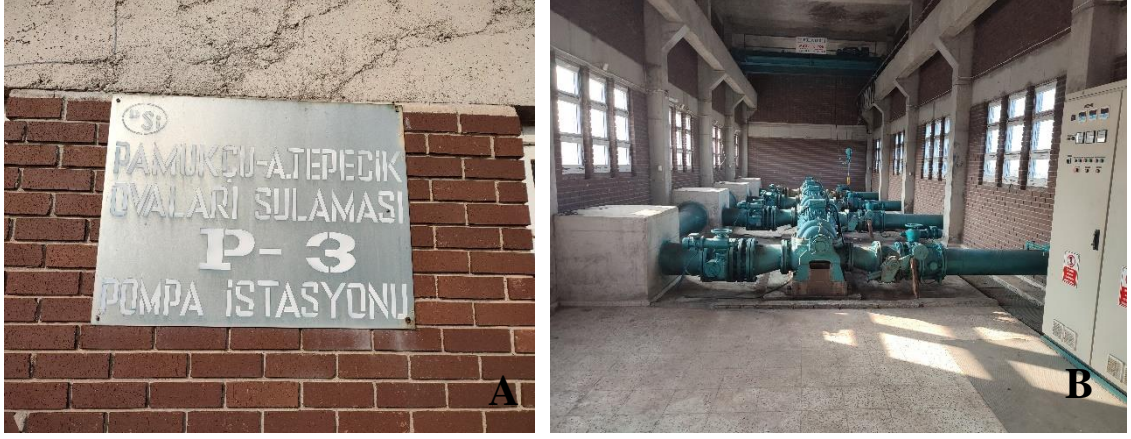
Şekil 3.5. Pamukçu ve Aslıhantepecik Ovası Sulaması A) P-3 Pompa İstasyonu B) Pompa Üniteleri
