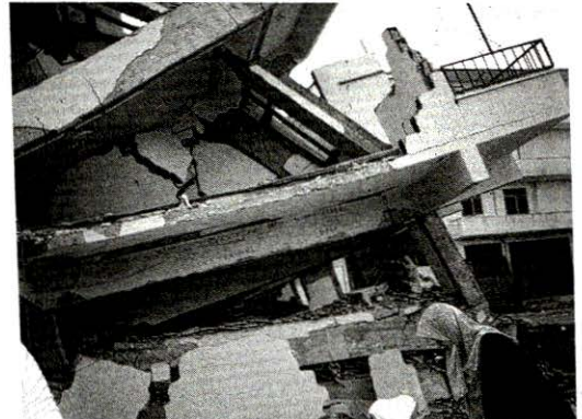
Taşıyıcı sistemin tamamen dağılması / BAHÇECİK
