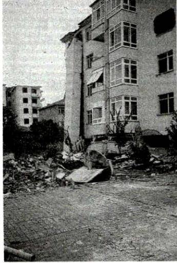
Baca ve yapının deprem etkisiyle hasar görmesi / BAHÇECİK
