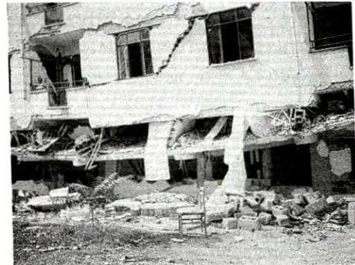
Yapı elemanlarında ağır hasar / GÖLCÜK
