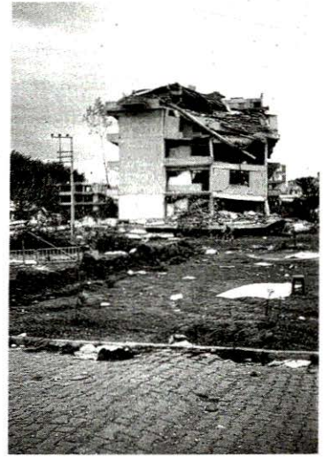
Zemin kat ve çatı katındaki ağır hasar / BAHÇECİK
