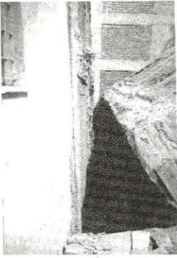
Zeminde sıvılaşma nedeniyle yapının devrilmesi/ADAPAZARI
