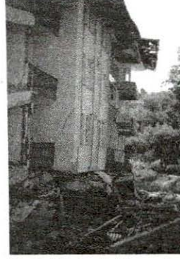
Yumuşak kat nedeniyle zemin ve birinci katın çökmesi/GÖLCÜK
