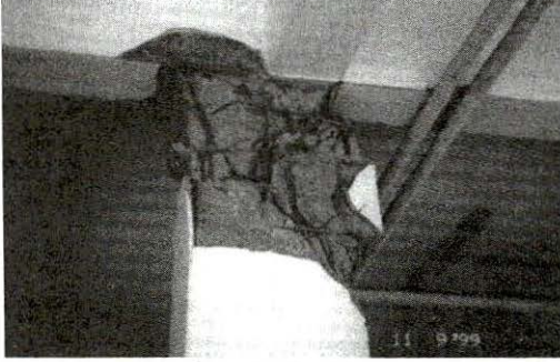
Kolon-kiriş bağlantı noktasında, donatı korozyonu ve etriye aralığının az olması nedeniyle mafsallaşma /ADAPAZARI
