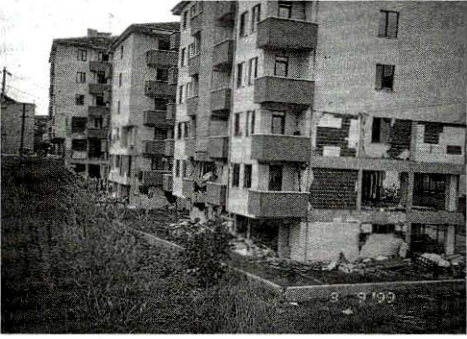
Isı yalıtımlı çift tuğla duvarlarda hasarlar kötü uygulama hasarları / YALOVA
