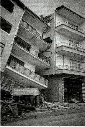
Yumuşak kat, çarpışma, sağlam bina çürük binayı tam göçmeden kurtarıyor / GÖLCÜK
