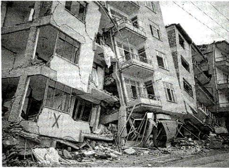
Ticari maksatla yapılan yumuşak kat, çökme, çarpışma / GÖLCÜK
