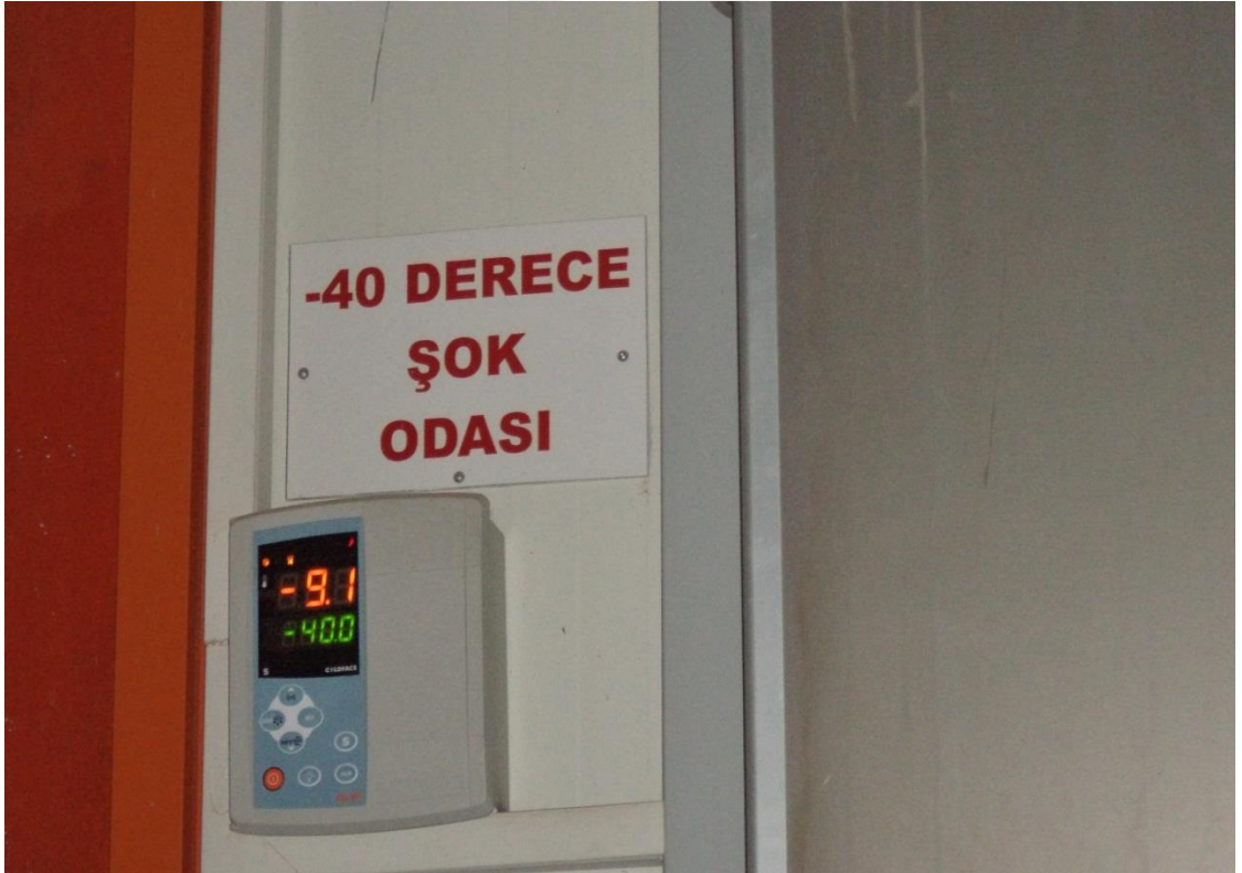
Şekil 4.14. Soğuk Hava İle Dondurma Odası Kontrol Paneli (Gürsu/BURSA)
