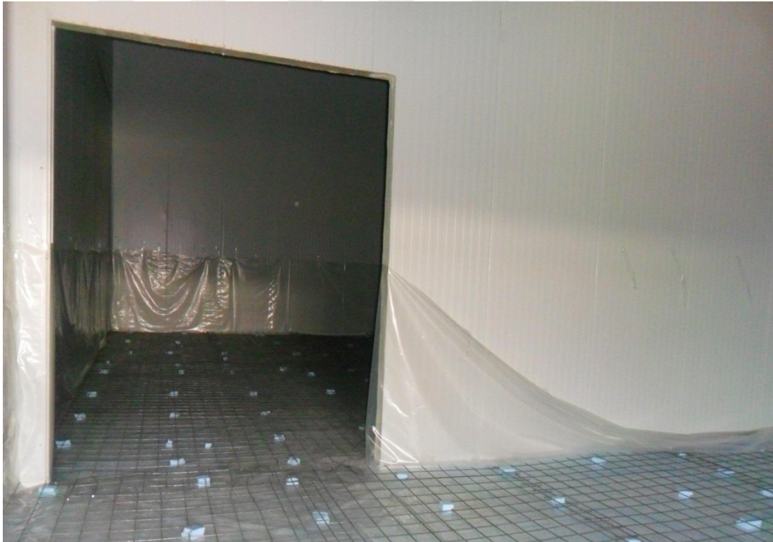
Şekil 4.32. KKYDP Kapsamında Kapasite Arttırımı ve Depo İçi Modernizasyon
