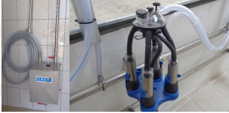
Şekil 3.5. Manüel yıkama sistemindeki yıkama teknesi, yıkama kadehine takılmış sağım başlığı, süt ve yıkama boru hattı görünüşü
