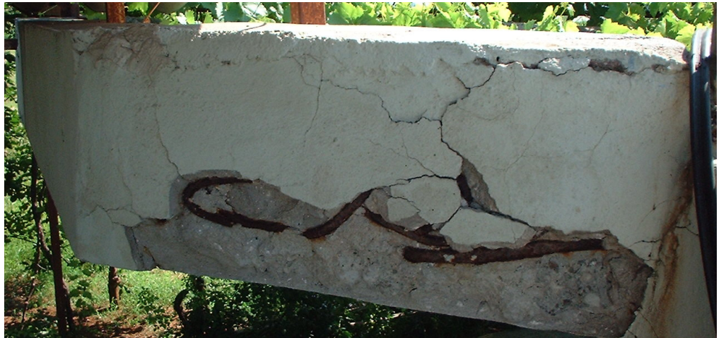
Şekil 2.29. Korozyona uğramış donatı (Z.Şimşek Arşivi 2003)
