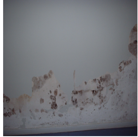
Şekil 2.27. Zemin suyunun bodrumsuz bir yapıda kapiler yolla yapı bünyesinde ilerleyerek oluşturduğu hasarlar. (Z.Şimşek Arşivi 2003).
