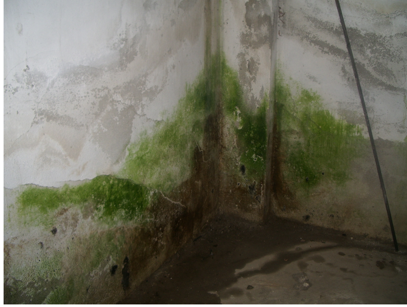
Şekil 3.12. Zeminden nemlenme sonucunda çiçeklenme olayı gözlenen yapı elemanı (Z. Şimşek arşivi 2005)
