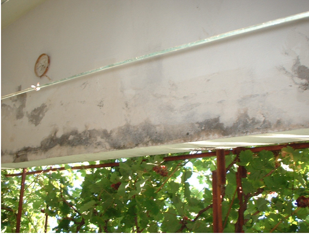
Şekil 2.26. Suyun kapiler yolla ilerleyerek taşıyıcı sistemde neden olduğu hasarlar (Z.Şimşek Arşivi 2003).
