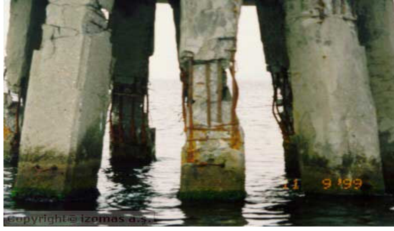
Şekil 3.14. Donatısı korozyona uğramış betonarme yapı ( www.izomas.com.tr )
