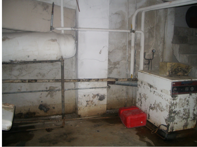
Şekil 2.21. Zemin suyunun bodrum kat iç mekânında ve donanımlarında oluşturduğu hasarlar (Z. Şimşek arşivi 2005)
