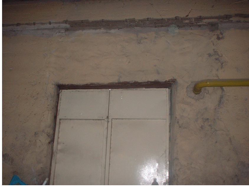
Şekil 2.22. Suyun bodrum iç mekânında oluşturduğu hasarlar (Z.Şimşek Arşivi 2003).
