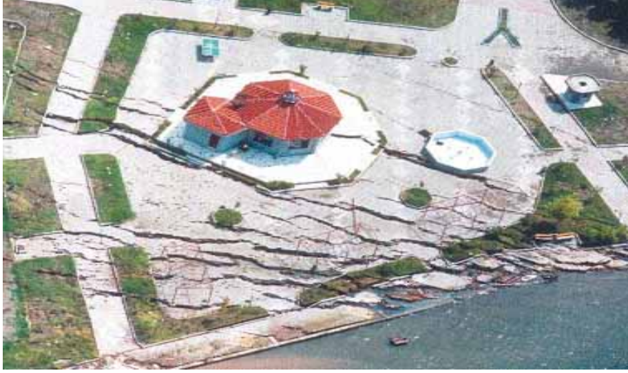
Şekil 4.1. Deniz kenarındaki dolgu zeminlerde deprem karşısında oluşan hasarlar
