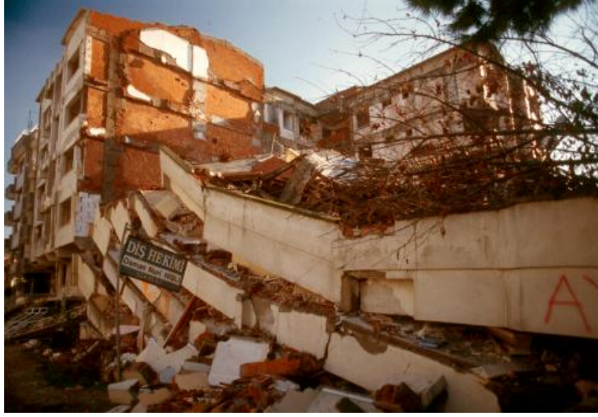
Şekil 4.29. Dilatasyon yapılmayan bitişik nizam yapıların deprem etkisi altında gördüğü hasarlar
