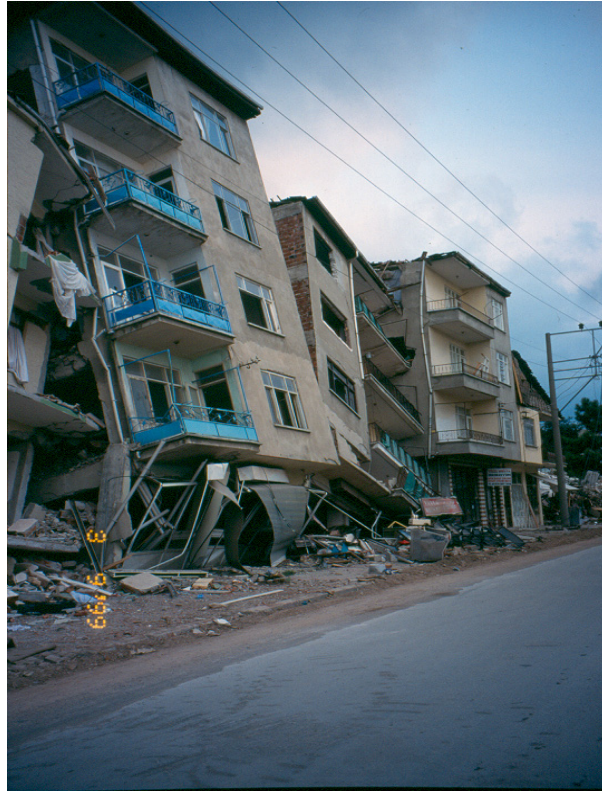
Şekil 4.30. Yapılarda Deprem Etkisiyle Çarpışma, Marmara Depremi-Gölcük
