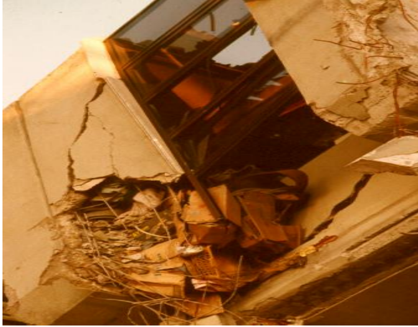
Şekil 4.36. 1999 Marmara Depremi'nden standartlara uygun beton ve donatı kullanılmamış bir yapı örneği
