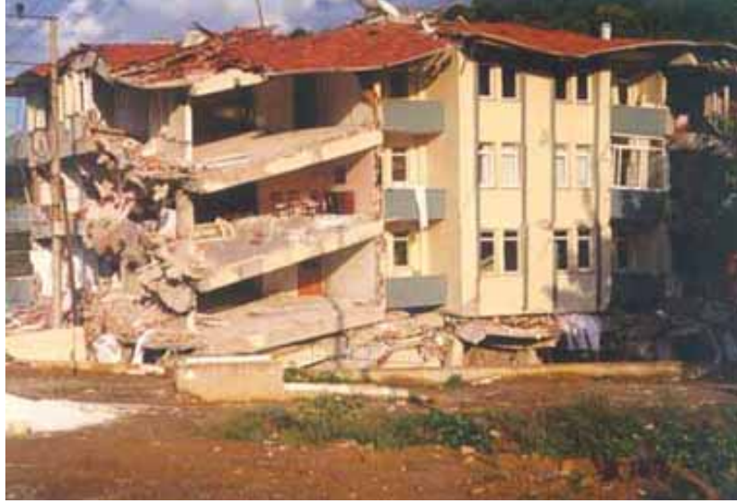
Şekil 4.32. Konsol miktarı fazla olan yapının deprem karşısında hasar görmesi
