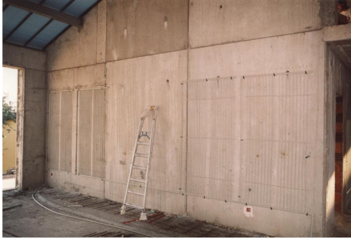
Şekil 4.11. Isıtma tesisatının iç mekan duvarına yerleşimi (Anonim 1)
