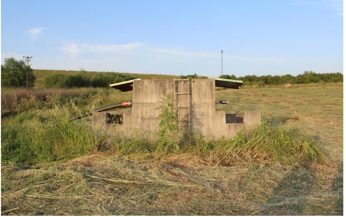
Şekil 3.6. Sulama alanındaki hidrantlara bir örnek (dıştan görünüm)
