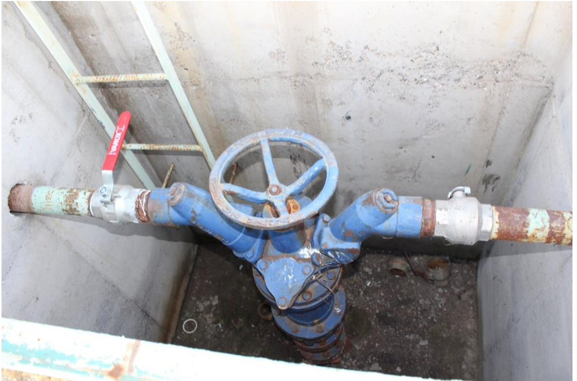
Şekil 3.7. Sulama alanındaki hidrantlara bir örnek (içten görünüm)
