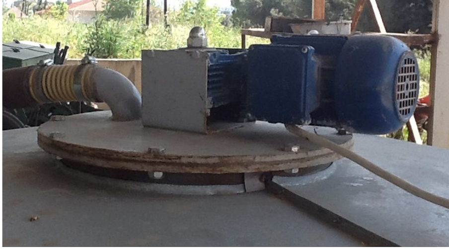
Şekil 3.7. Karıştırıcı mil, redüktör ve elektrik motoru
