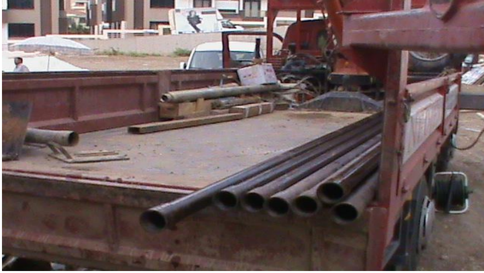
Şekil 4.11. Kolon boruları (çapı 63,5 mm)
