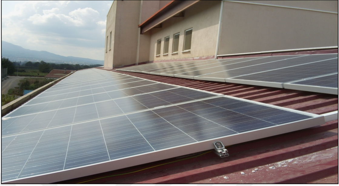
Şekil 3.2. Fotovoltaik güneş enerjisi tesisinin genel görünümü
