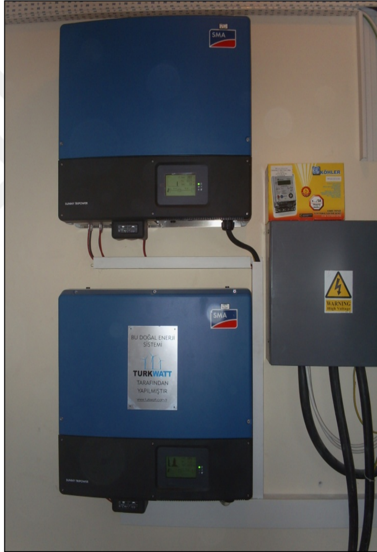
Şekil 3.4. Fotovoltaik güneş tesislerine ait inverterler
